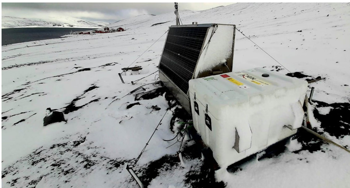
Figura 2.- Instalación por parte del IGN del sistema de alimentación eléctrica, mediante pila de metanol, propuesto por el CNH2, en la estación de vigilancia volcánica BASE en isla Decepción.
