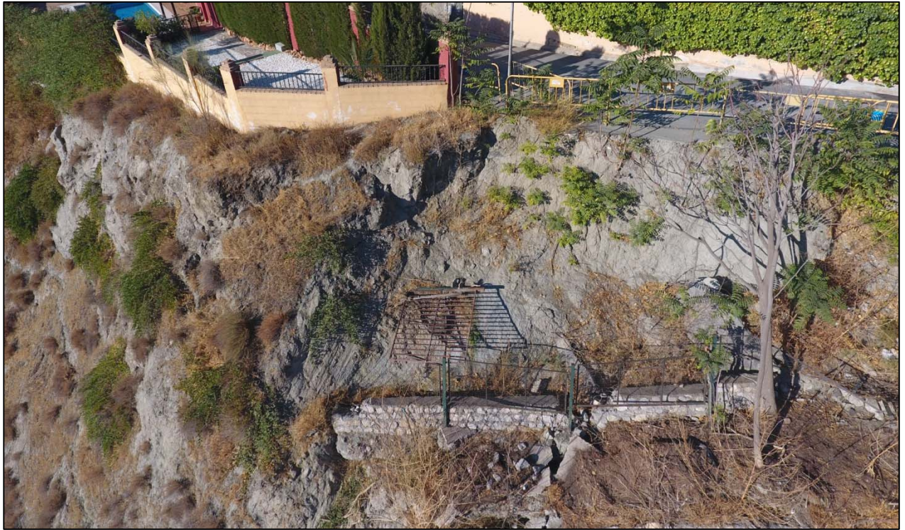
Calle Nardos. Desplazamiento de muro de mampostería y valla de cerramiento (Fuente: Oriol Ingeniería Civil)
