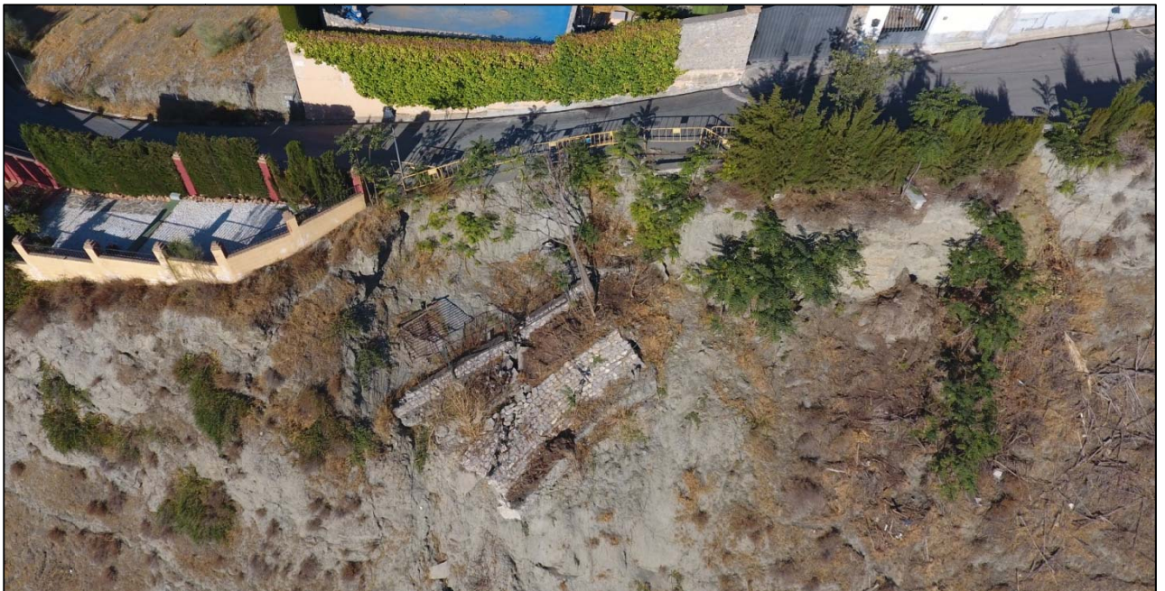
Calle Nardos. Fotografía aérea de la zona afectada por el deslizamiento del talud. (Fuente: Oriol Ingeniería Civil)
