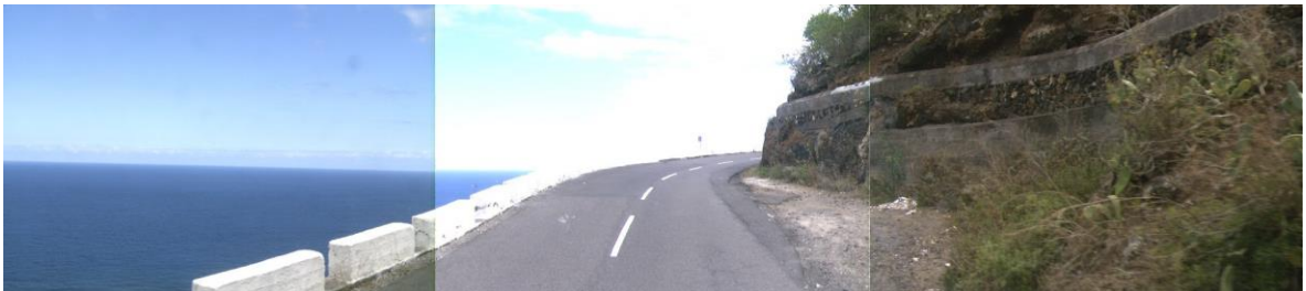
FOTO 8: Sobreechamiento sin ordenar P.K. 3+110
