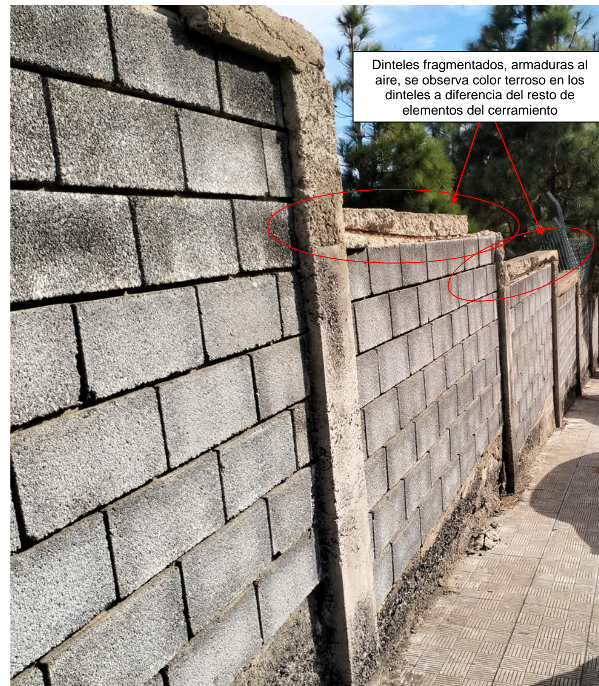
Estado de dinteles de HA del cerramiento, rotura y armaduras vistas
