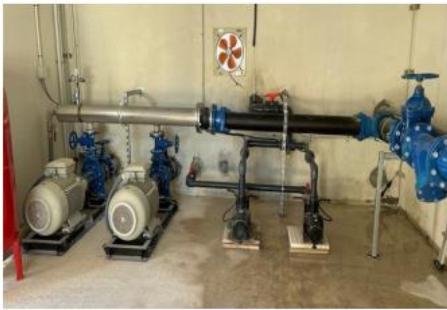
Bombas de presión y recirculación
