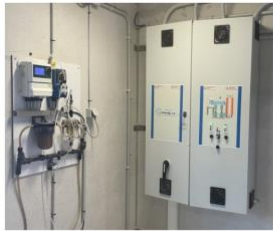
Analizador cloro y variadores bombas
