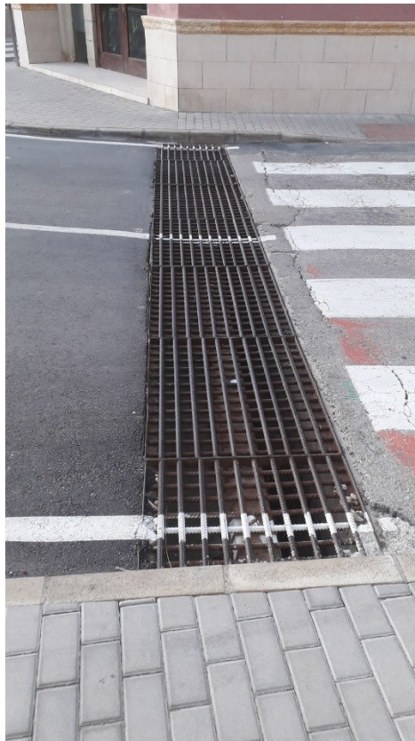
Foto de uno de los sumideros lineales existentes.
