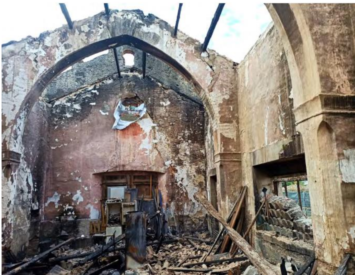
Imagen posterior al incendio
