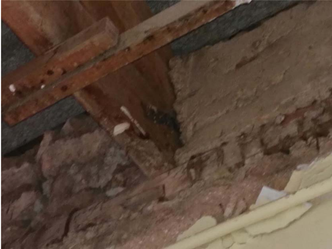
Detalle de apoyo de la cercha sobre durmiente de madera dispuesto en coronación de muros de carga.
