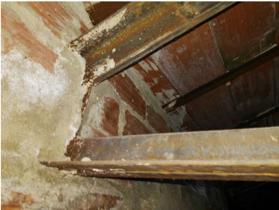
Detalle del apoyo de la cercha metálica sobre viga de hormigón corrida sobre el muro de carga.
