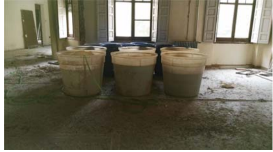
Detalle 3er escalón de carga
