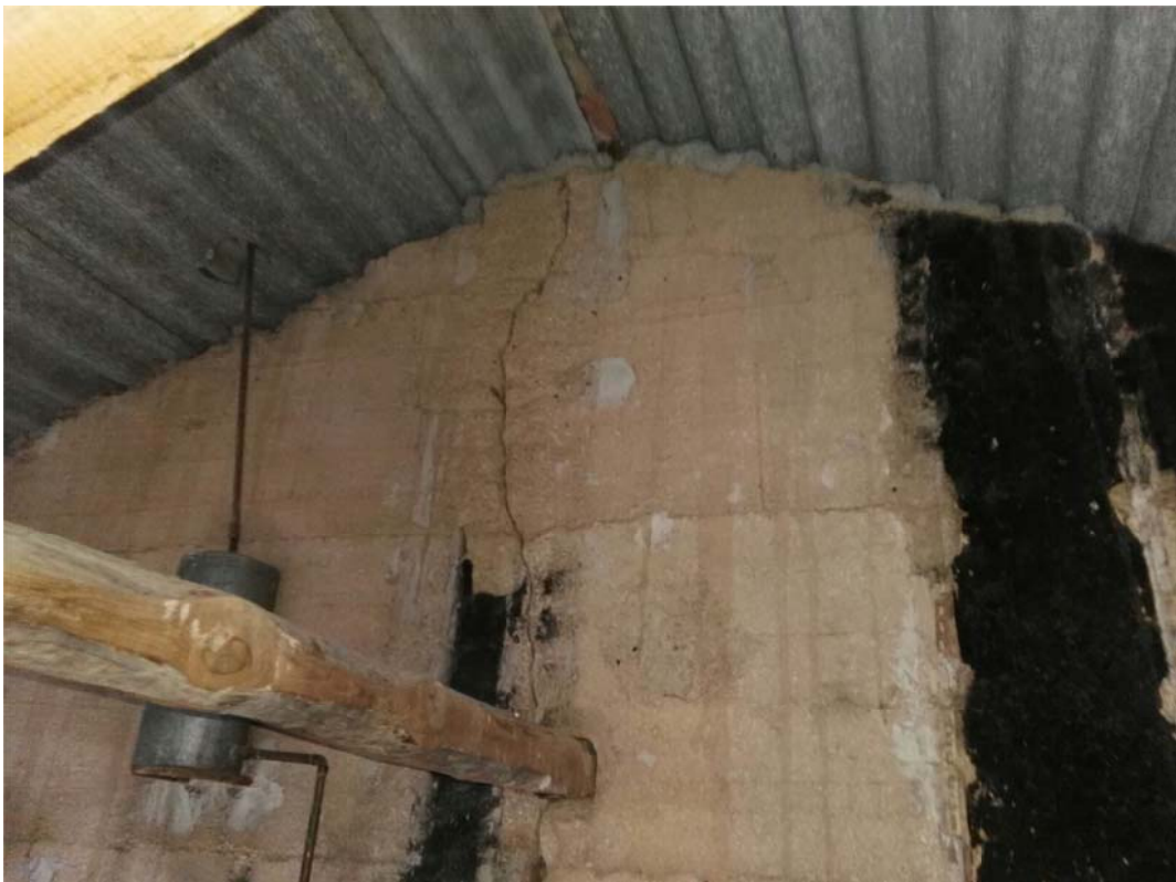
Grieta vertical en muro hastial, recorre el mismo en toda su altura.
