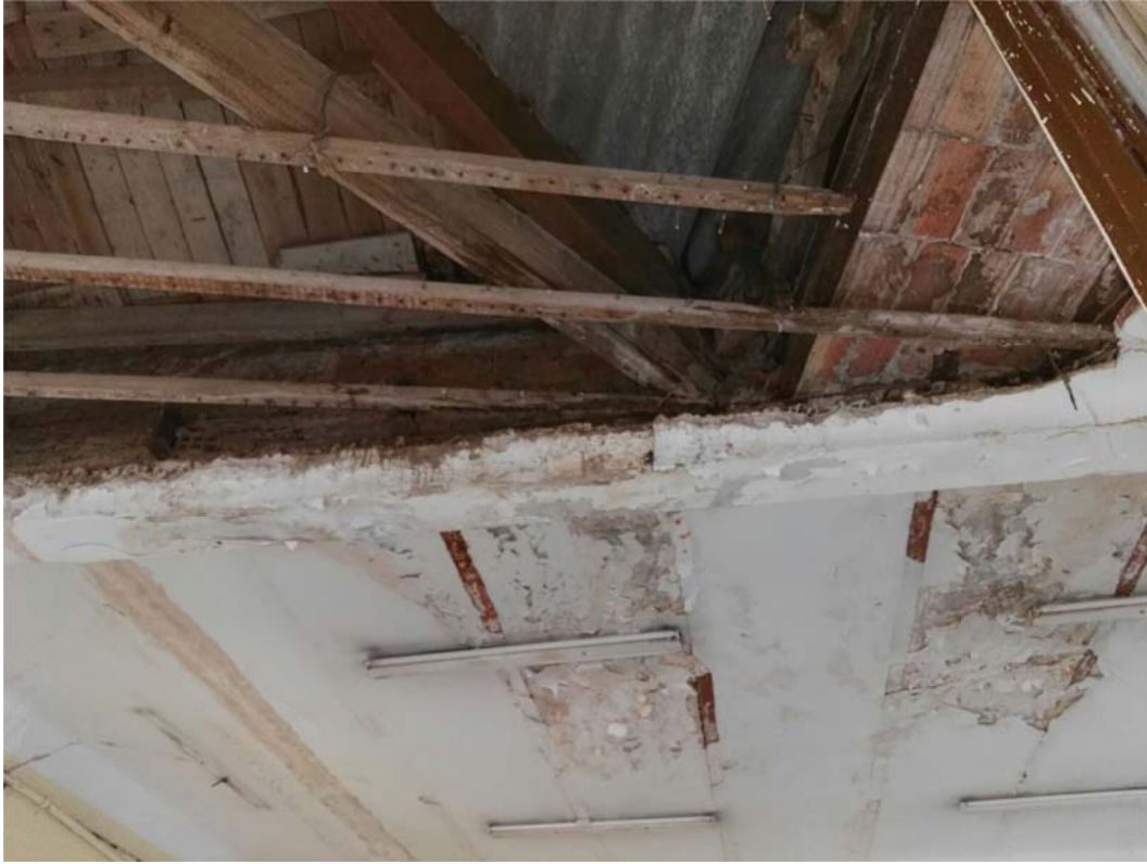
Zona afectada por la humedad, sobre la cercha que acomete en la zona de acceso.
