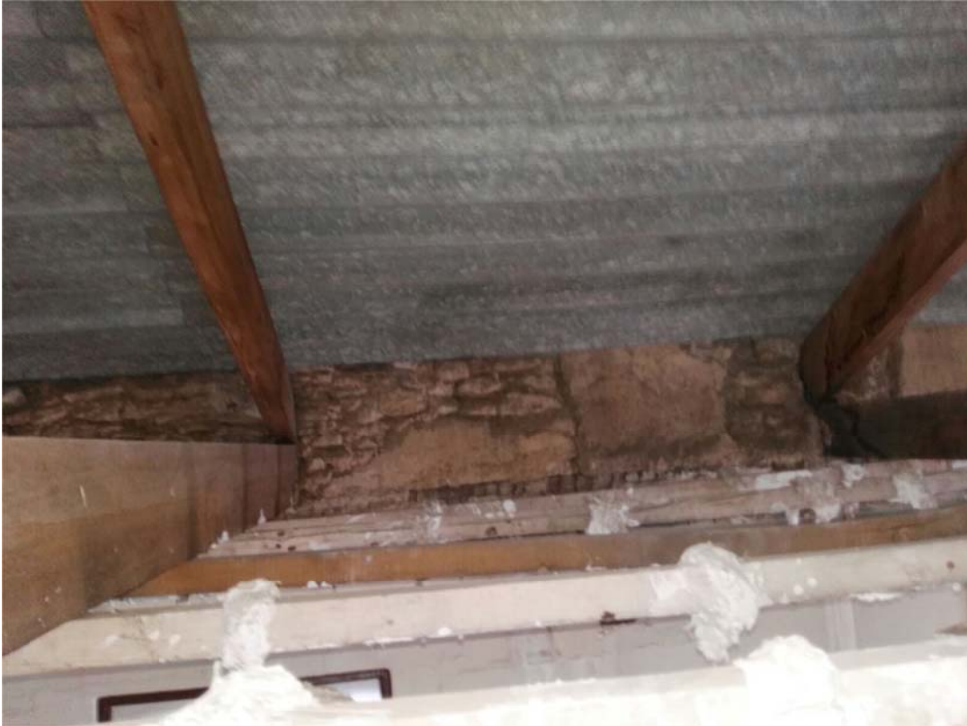
Vista del apoyo de la cercha, cubrición de fibrocemento. Este material está actualmente prohibido y considerado como residuo peligroso.
