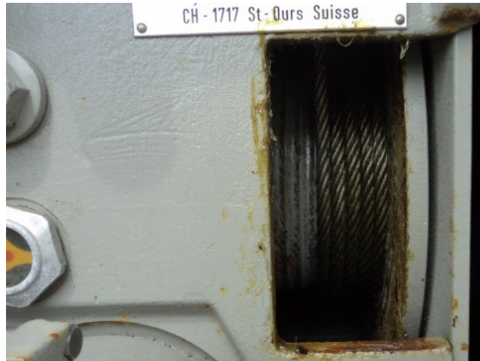
Figura 5. Ventana para la comprobación del estado y engrase del cable.
