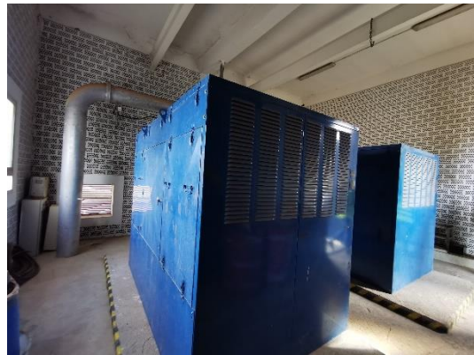
Ilustración 20 Interior edificio de soplantes
