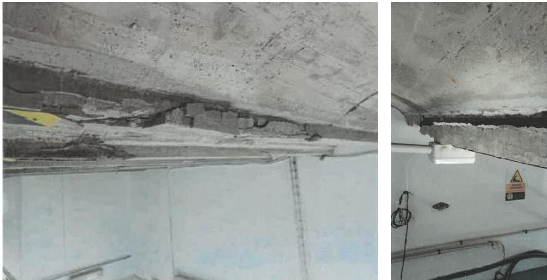
Ilustración 11 Desperfectos en la cámara de acceso
