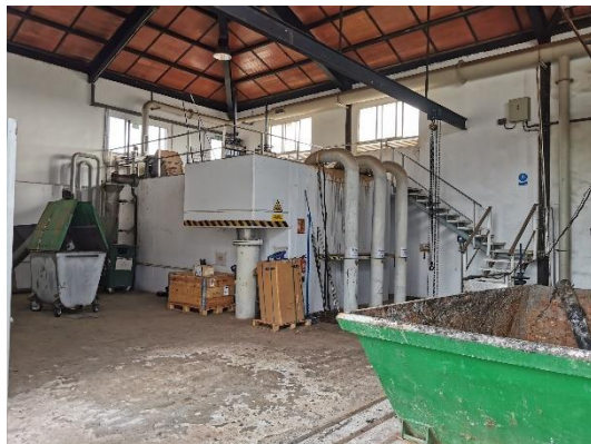
Ilustración 15 Interior edificio pretratamiento
