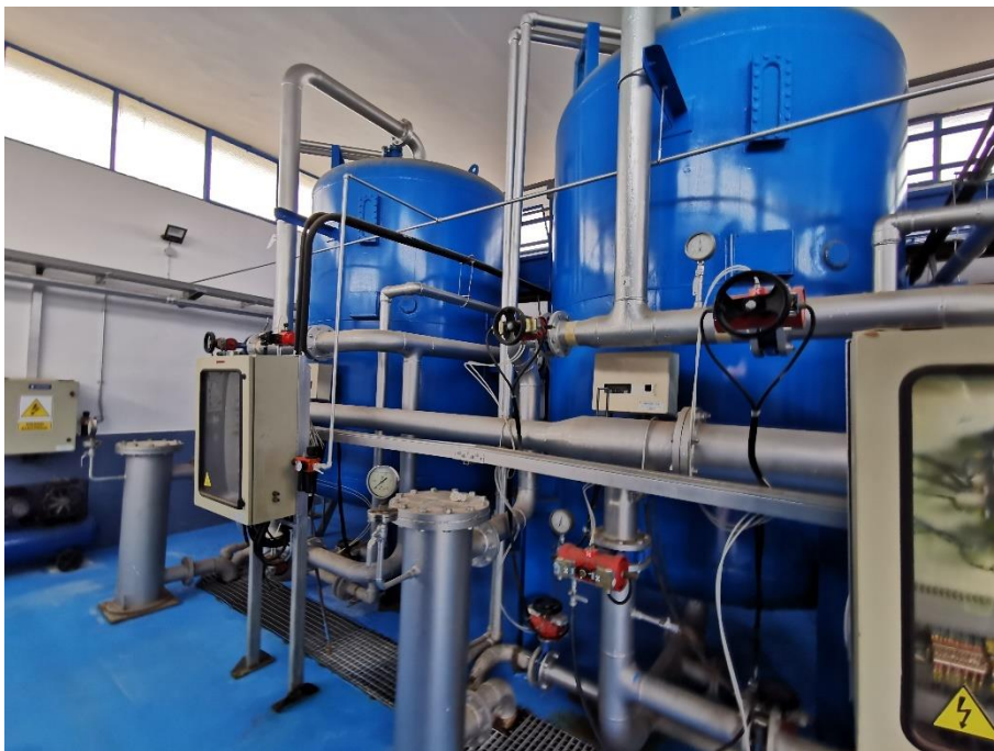
Ilustración 8 Interior edificio descalcificación
