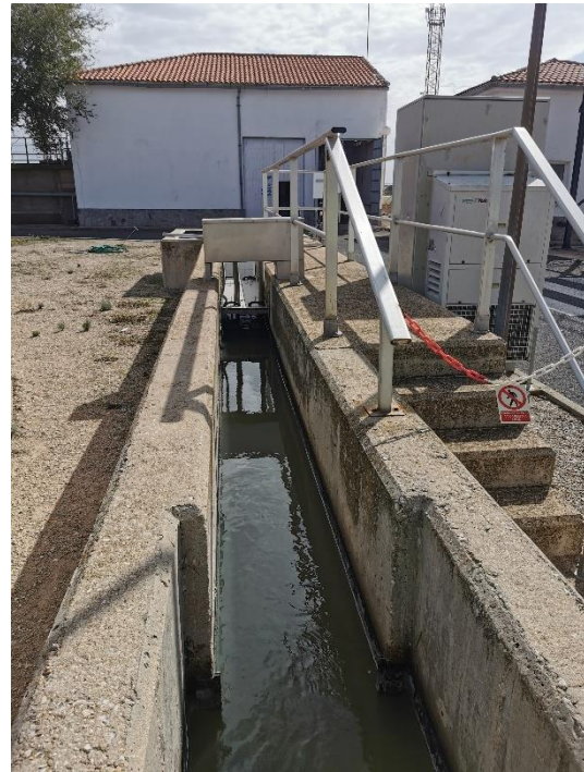
Ilustración 14 Canal de desinfección, salida de EDAR
