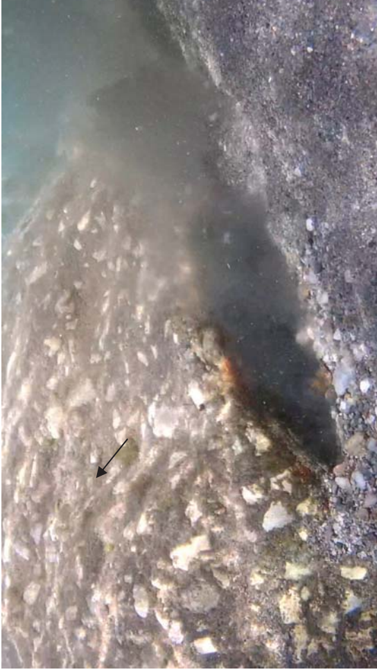
Justo antes de perderse la traza de la conducción bajo la arena de la playa se observa una leve fuga de efluente saliendo de una abertura de 12 cm. de una laja de hormigón.
