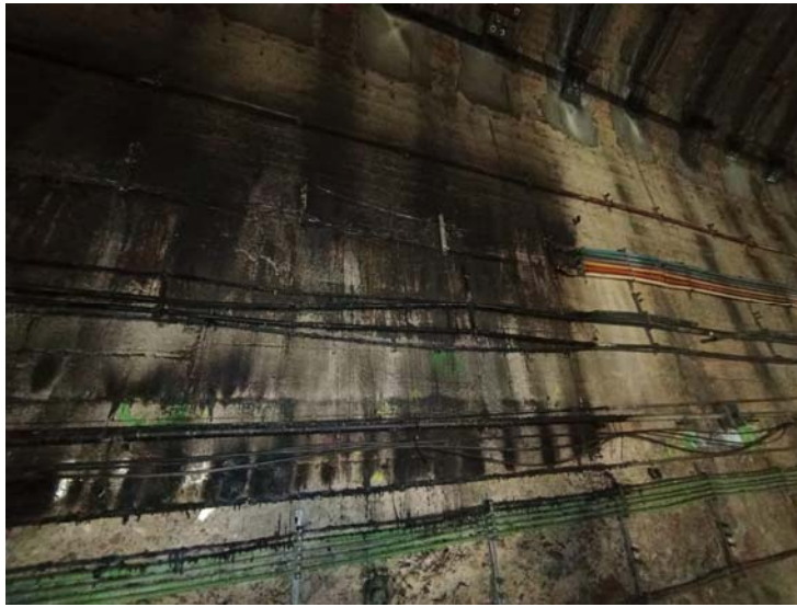
Cables de señalización quemados
