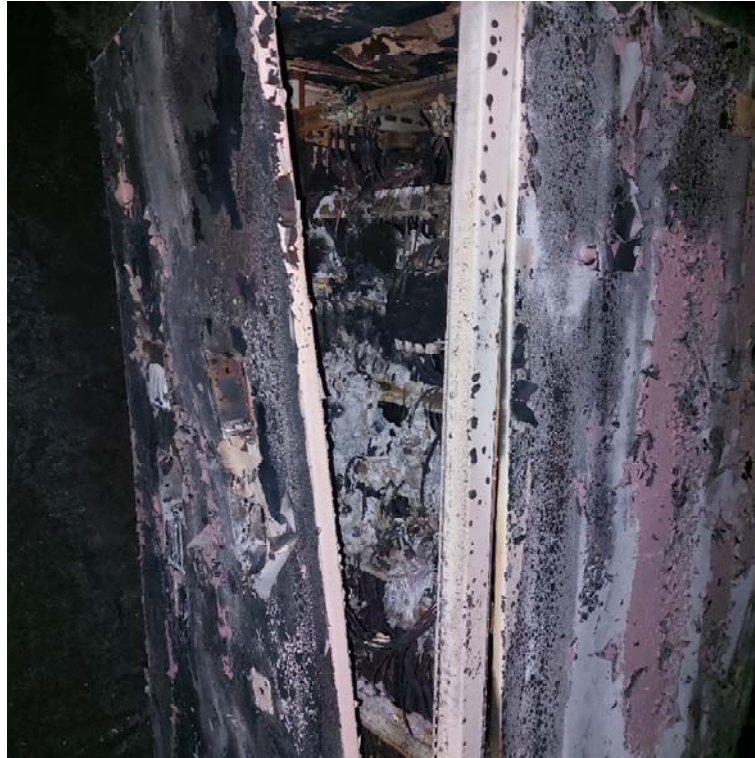
Armario de Energía en el SSI
