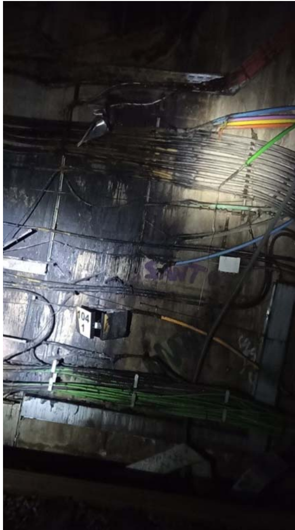
Cables de señalización y fibra óptica quemados
