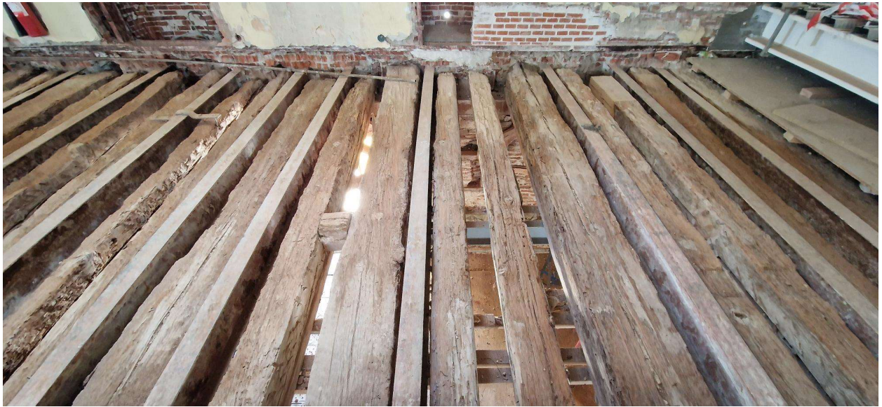
Fotografía 1. Vista de la cara superior de las vigas.
