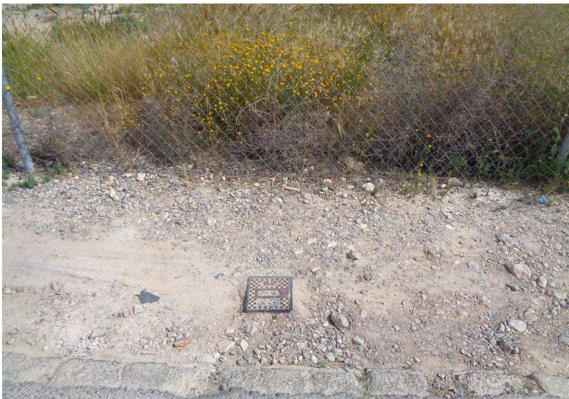
FOTOGRAFÍA 8: Vista de arqueta de instalación de agua potable en fachada del solar.
