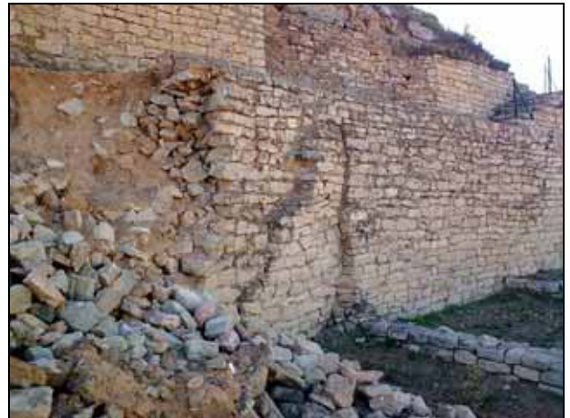
Vista del extremo derecho del muro donde se observa un trasdós de piedra adosado a rellenos
