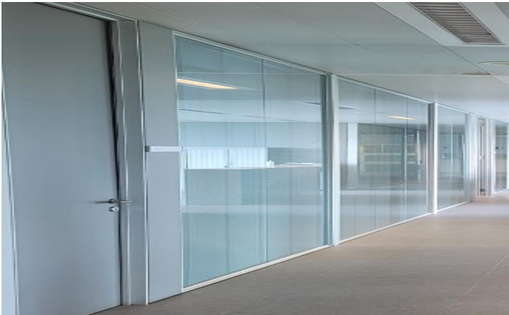
4.Mampara cristal con puerta paralela fachada.
