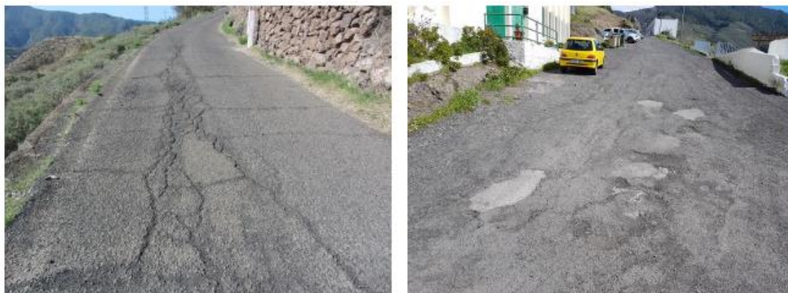
Fotos 5 y 6 – Fotos del estado del firme actual
