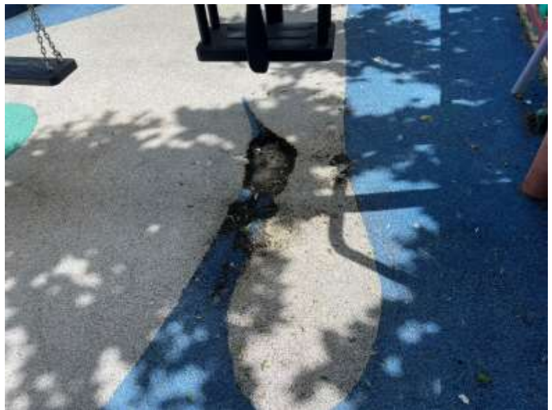
Pavimento elástico desgranado
