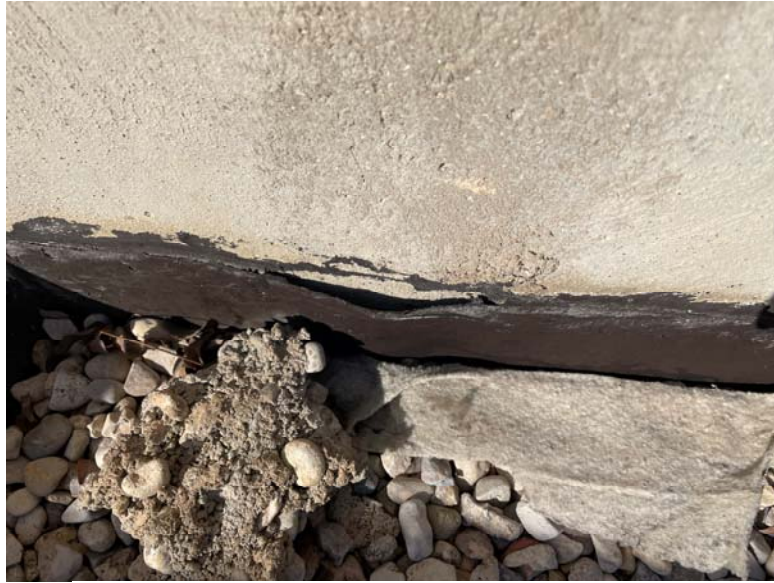
ESTADO DE TELA ASFALTICA CON PARAMENTOS VERTICALES
