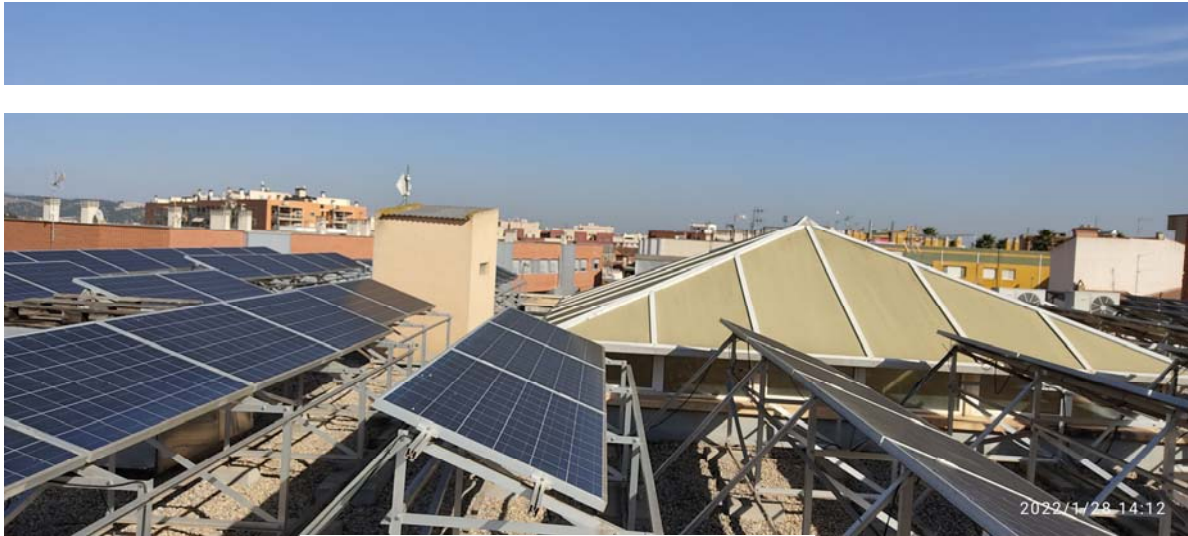
PLACAS FOTOVOLTAICAS EXISTENTES
