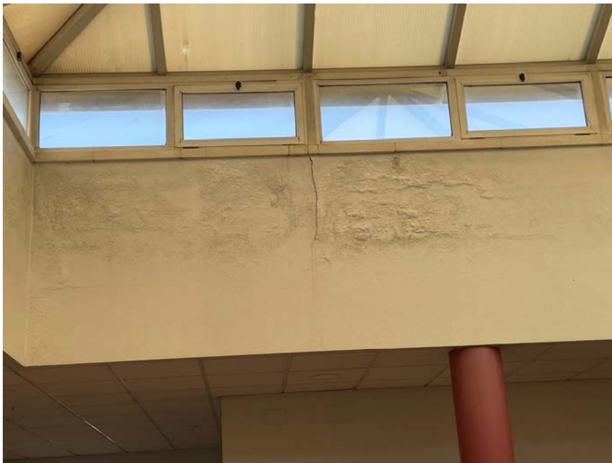
FILTRACIONES A TRAVES DE LA CUBIERTA
