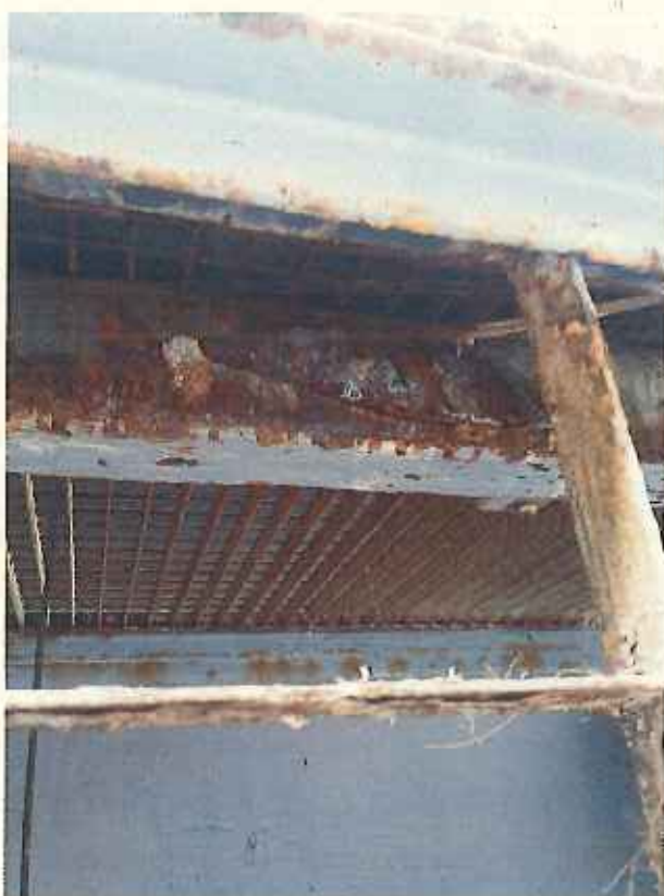
Foto 8- Detalle de oxidación de estructura sustentadora
