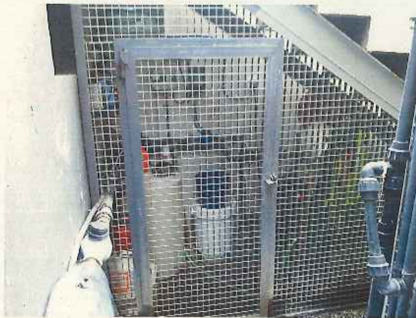
Foto 5- Cuarto técnico bombeo y control de riego
