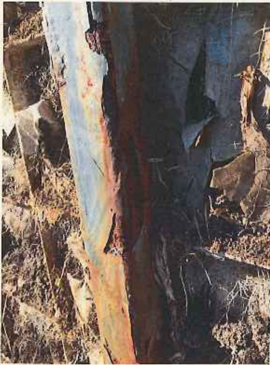
Foto 9- Detalle de oxidación de estructura sustentadora y deterioro de los sacos portantes
