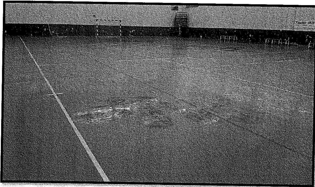
CHARCOS PRODUCIDOS POR LA LLUVIA EN EL INTERIOR DEL PABELLÓN
