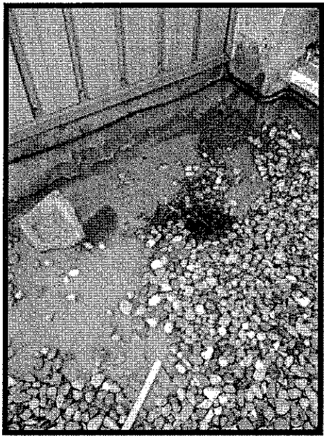
ENCUENTROS CON PARAMENTOS CON DESPERFECTOS
