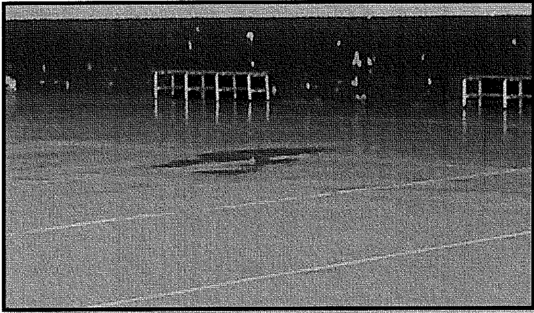
CHARCOS DE AGUA DE LLUVIA EN EL INTERIOR DEL PABELLÓN
