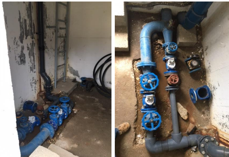
Entrada y control caudalímetros a la estación de bombeo
