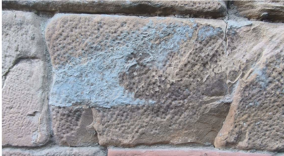
Detalle de sillar con pérdida del mortero de rejuntado, arenización y tratamiento inadecuado con mortero de cemento.
