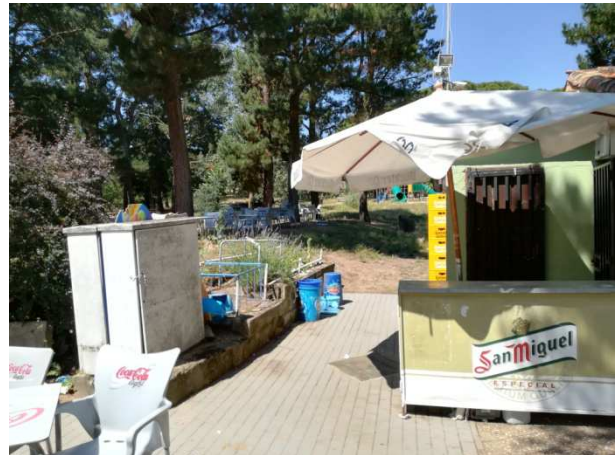
Punto de acometida eléctrica
