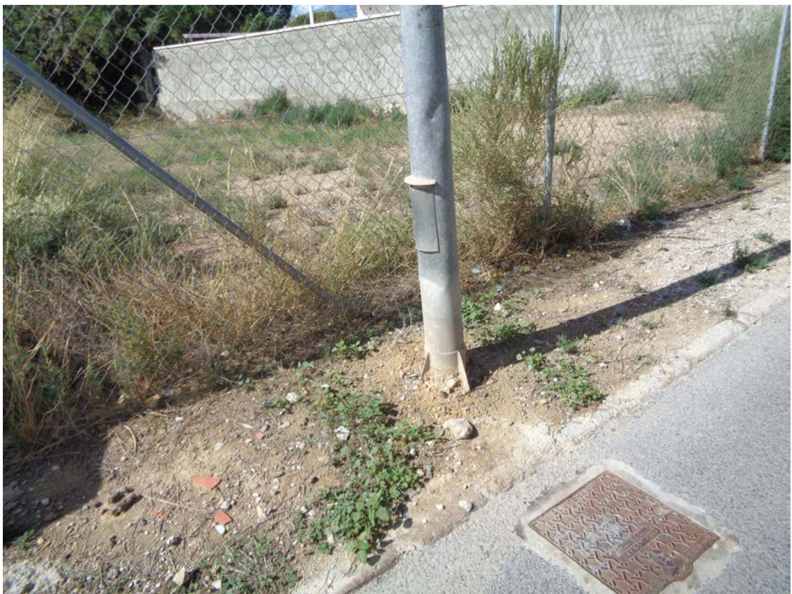
FOTOGRAFÍA 6: Vista de arqueta de alumbrado público.
