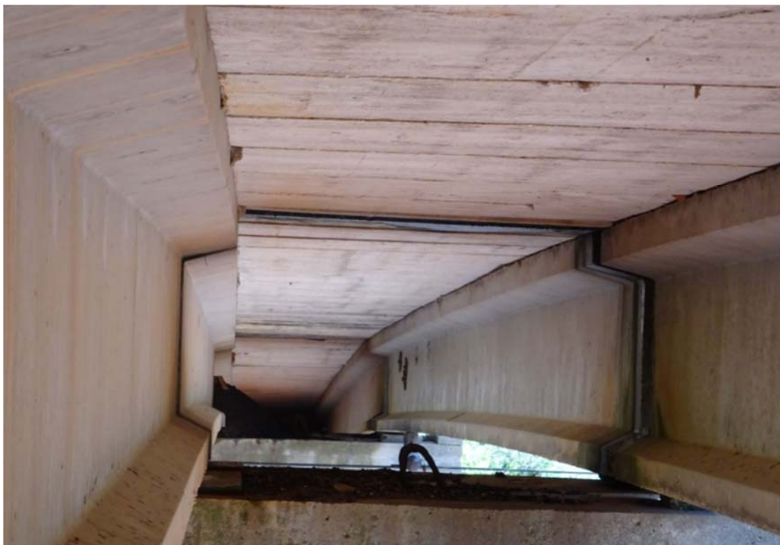
Imagen 9. Estado de los neoprenos bajo vigas número 4 y 5, de ambos dinteles, desde estribo derecho.
