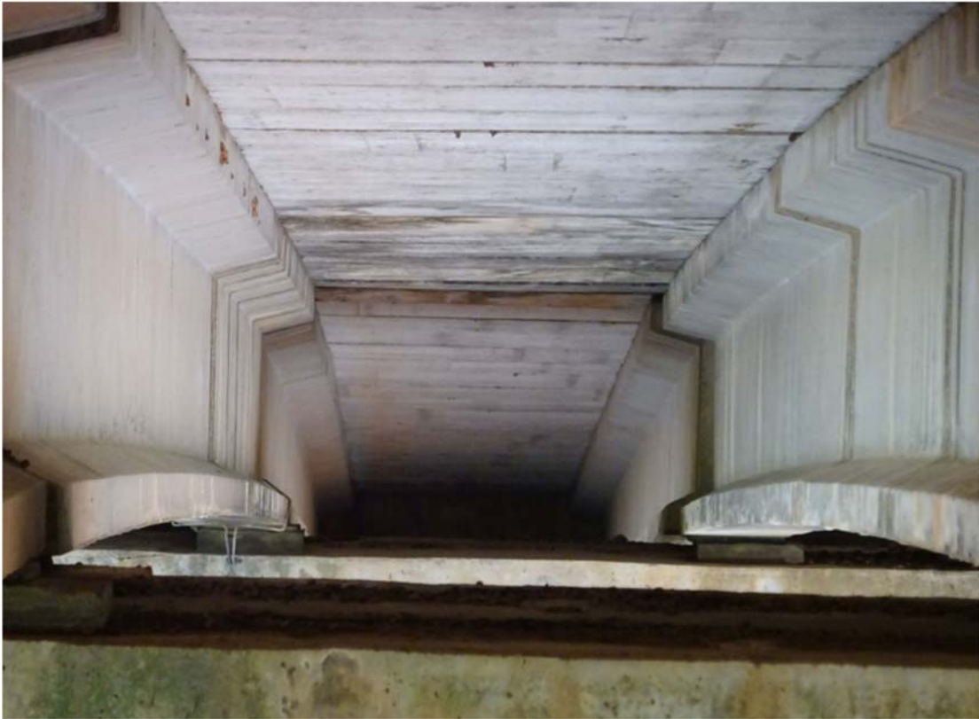
Imagen 10. Estado de los neoprenos bajo vigas número 2 y 3, de ambos dinteles, desde estribo derecho.
