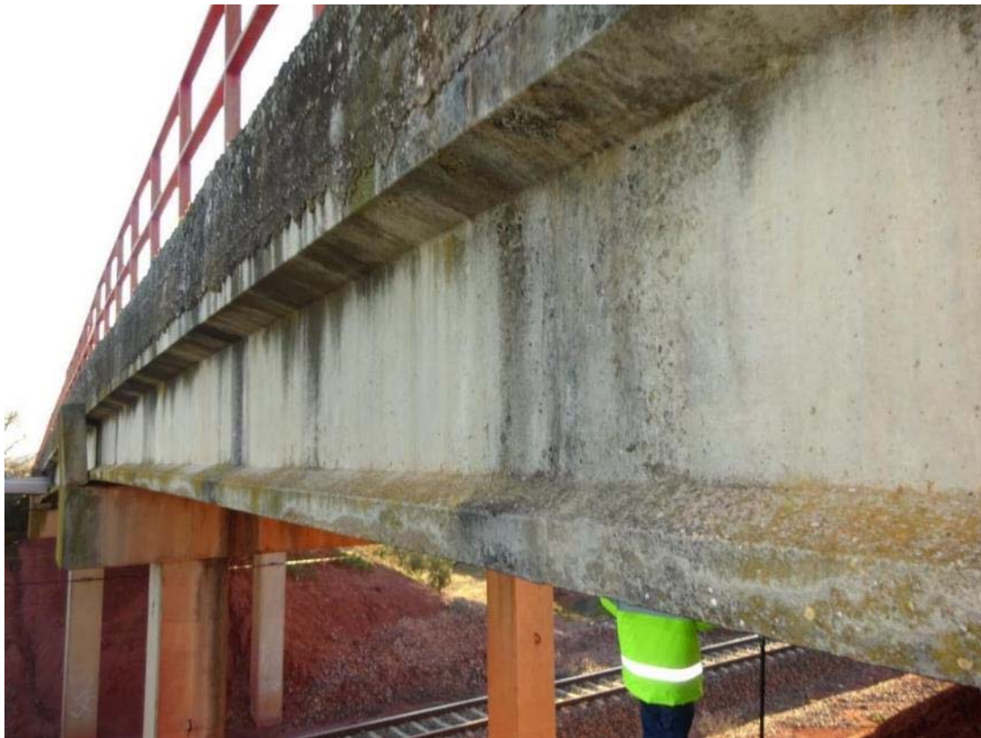
Imagen 13. Detalle del tablero haciendo tope con el parapeto del dintel de PK+, en el que se observa la inclinación del mismo.
