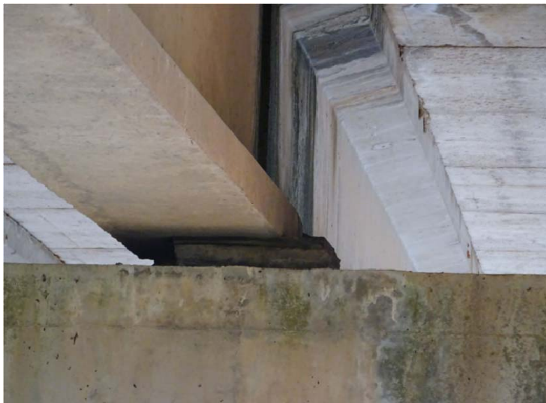
Imagen 5. Estado de los neoprenos bajo las vigas número 2, del dintel entre vano ferroviario y vano derecho, que evidencia el desplazamiento lateral del tablero.
