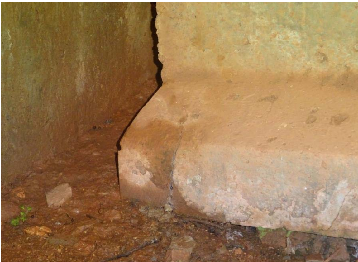
Imagen 16. Detalle de fisuración del ala inferior de la viga 2 en su apoyo en el cargadero del estribo izquierdo.
