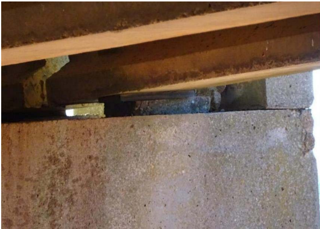
Imagen 11. Estado del neopreno bajo viga número 5, pk+, del dintel entre vano ferroviario y vano derecho.
