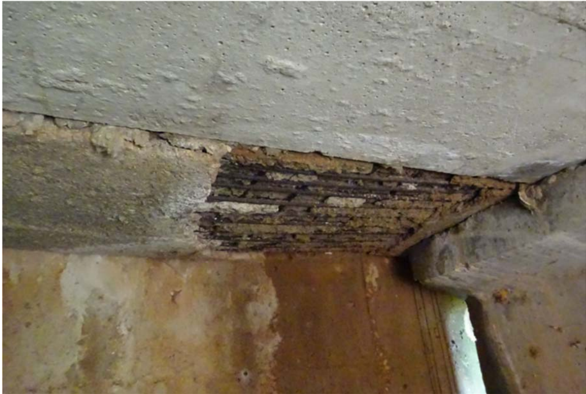
Imagen 15. Detalle de armaduras vistas corroídas entre vigas en la parte del estribo derecho.
