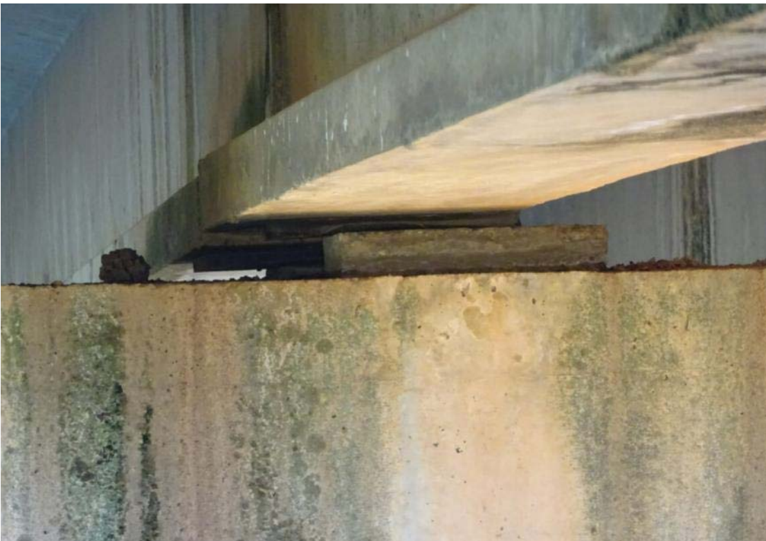
Imagen 7. Estado de los neoprenos bajo las vigas número 4, del dintel entre vano ferroviario y vano derecho, que evidencia el desplazamiento lateral del tablero.
