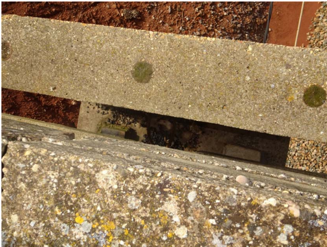
Imagen 4. Estado de los neoprenos en el lado de los PK - en el dintel entre vano ferroviario y vano derecho.
