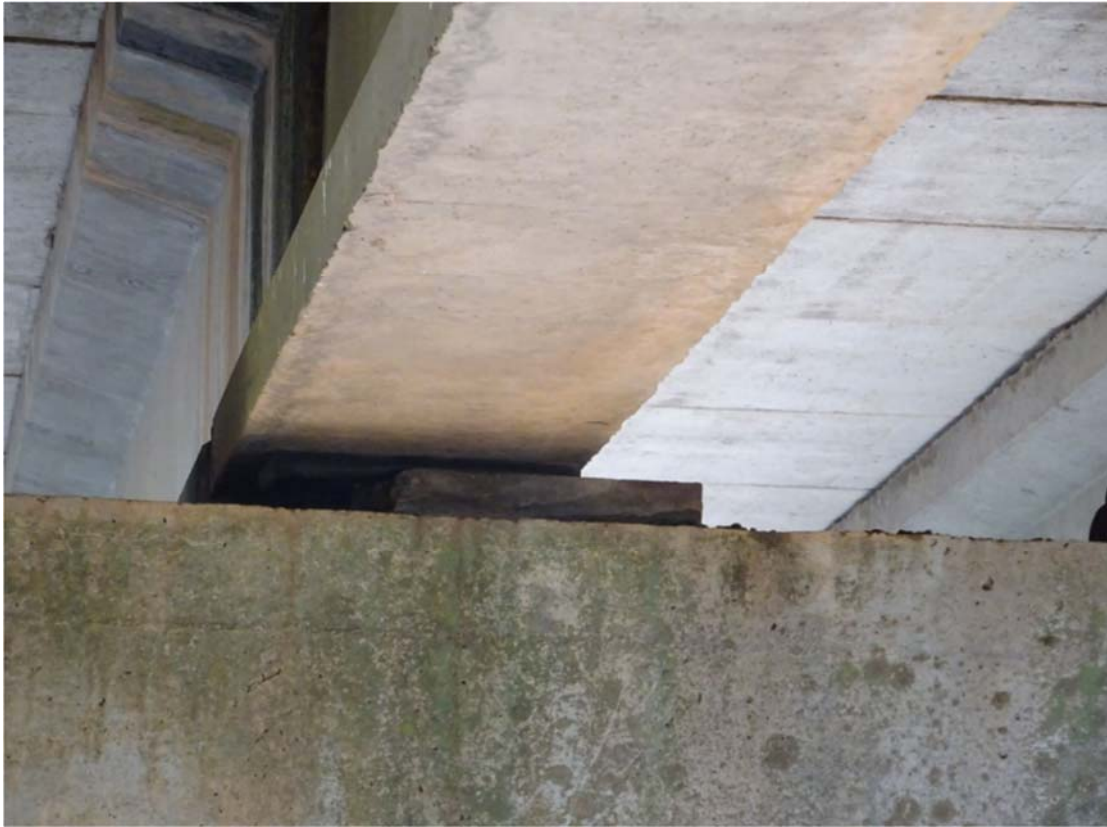
Imagen 6. Estado de los neoprenos bajo las vigas número 3, del dintel entre vano ferroviario y vano derecho, que evidencia el desplazamiento lateral del tablero.
