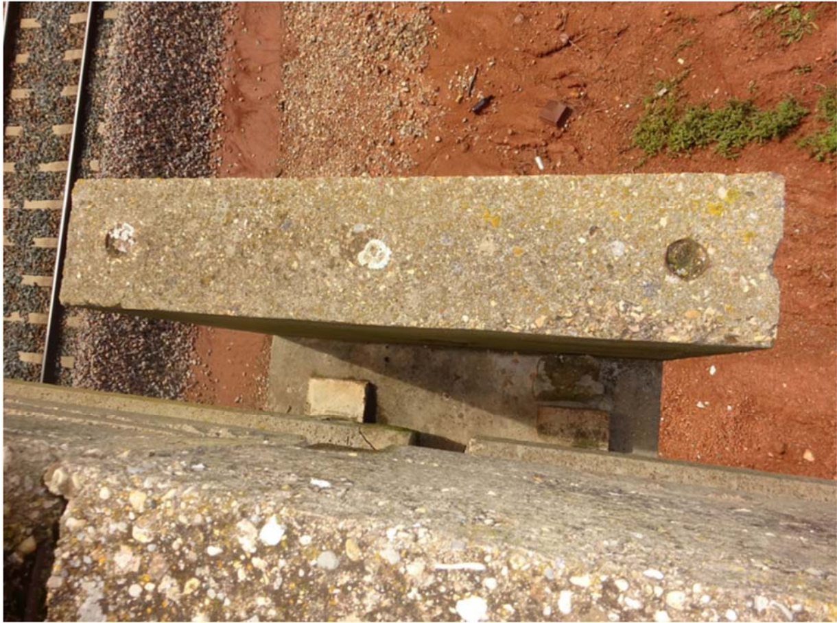
Imagen 3. Estado de los neoprenos en el lado de PK- en el dintel entre vano ferroviario y vano izquierdo, colocados en la vía mirando a PPKK crecientes.
