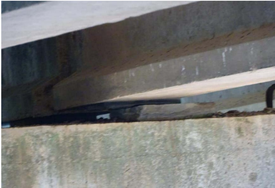
Imagen 8. Estado del neopreno bajo viga número 4, del dintel entre vano ferroviario y vano derecho.
