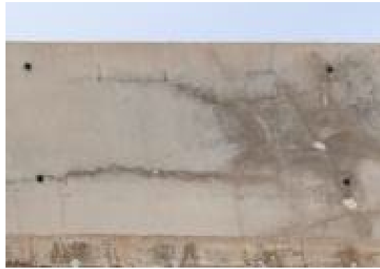
Zona de fisuras de hormigón en masa.
