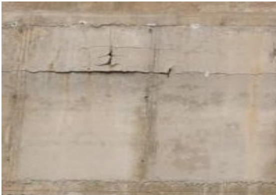
Zona de oxidación de armadura.
