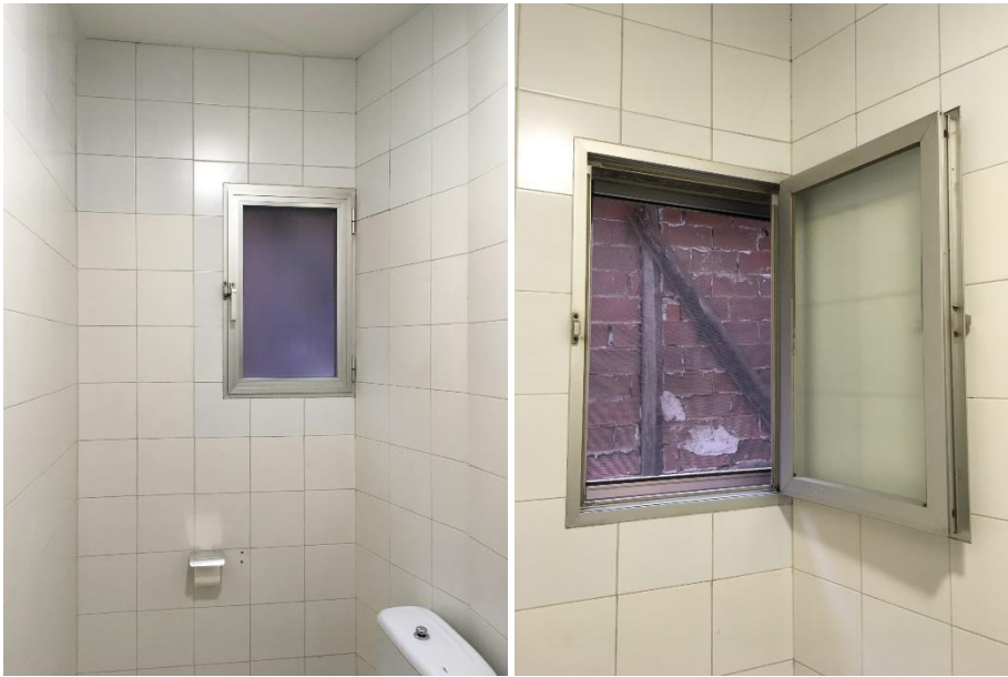
Foto 9. Planta primera. Baño nº 1.
