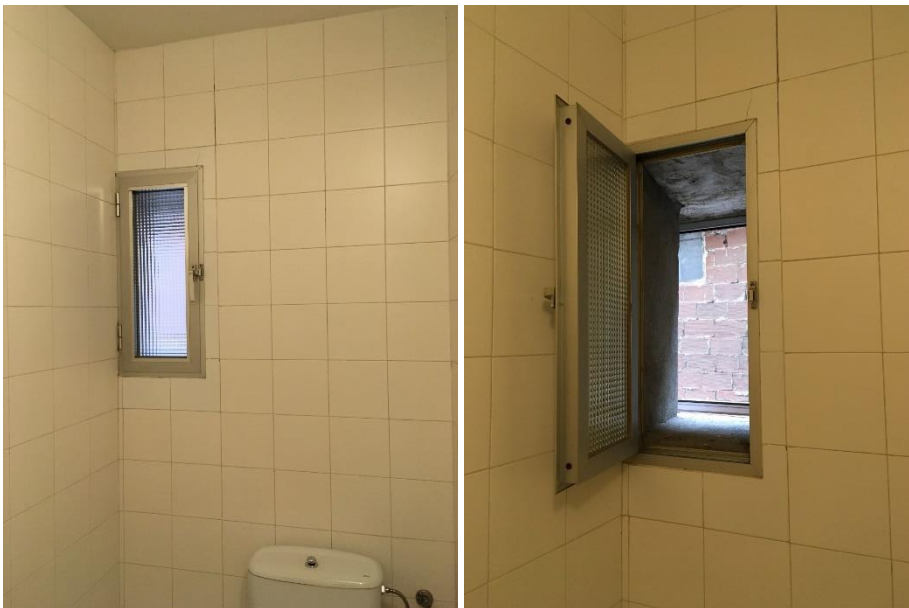
Foto 10. Planta primera. Baño nº 2.
