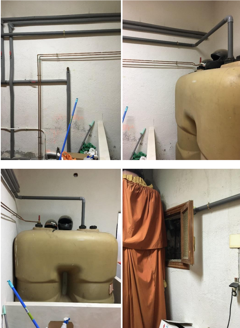
Foto 4. Planta baja. Sala de calderas.
