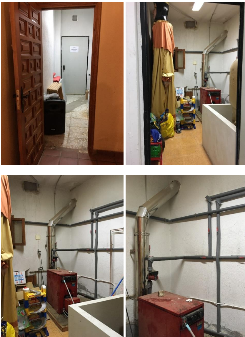
Foto 3. Planta baja. Sala de calderas.
