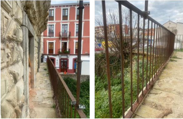
Balcones con oxidación de elementos de cerrajería y pérdida de estanqueidad de los sillares en voladizo
