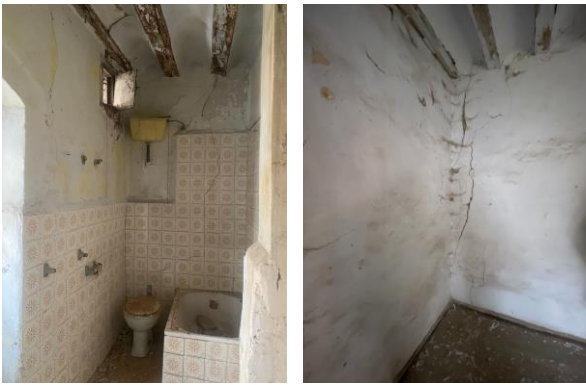
Fisuras en la cara interior del muro de fachada y en el muro transversal
