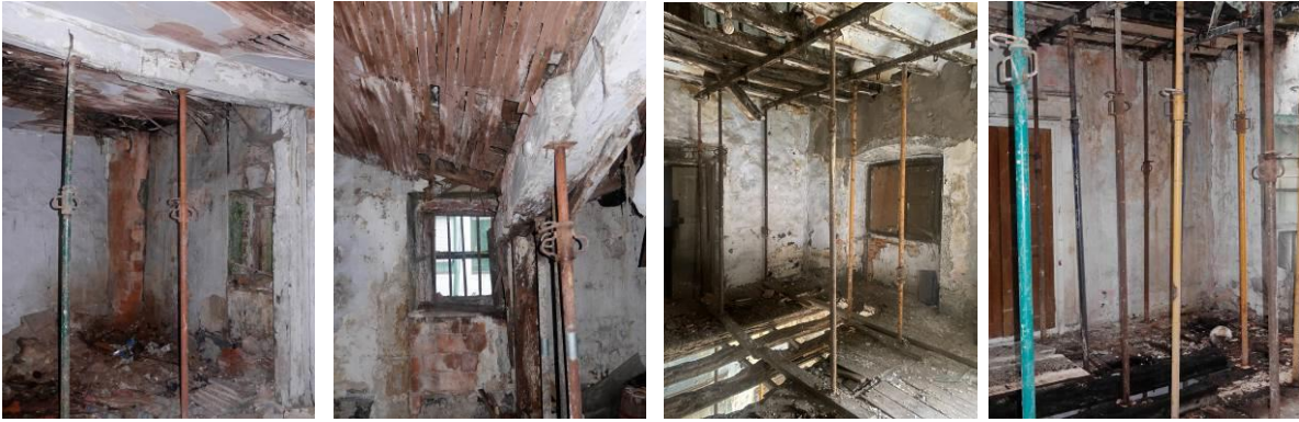
Forjados deteriorados con apeos en espacios de diversas plantas
