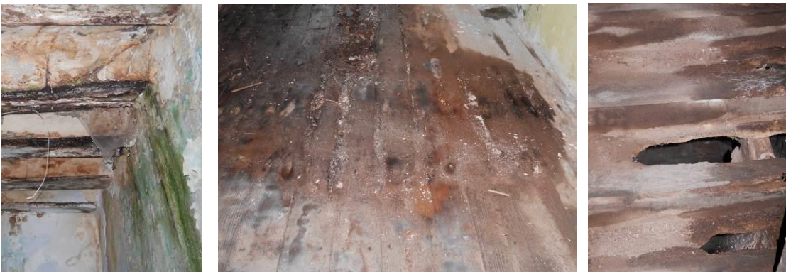
Forjados, tillos y peldaños deteriorados por la entrada de agua
