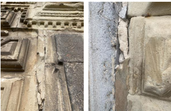
Juntas de los recercados de piedra caliza y la plementería de piedra arenisca deteriorados
