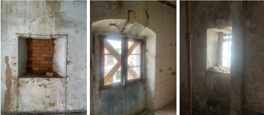
Fisuras en dinteles interiores y desprendimiento de dovelas
