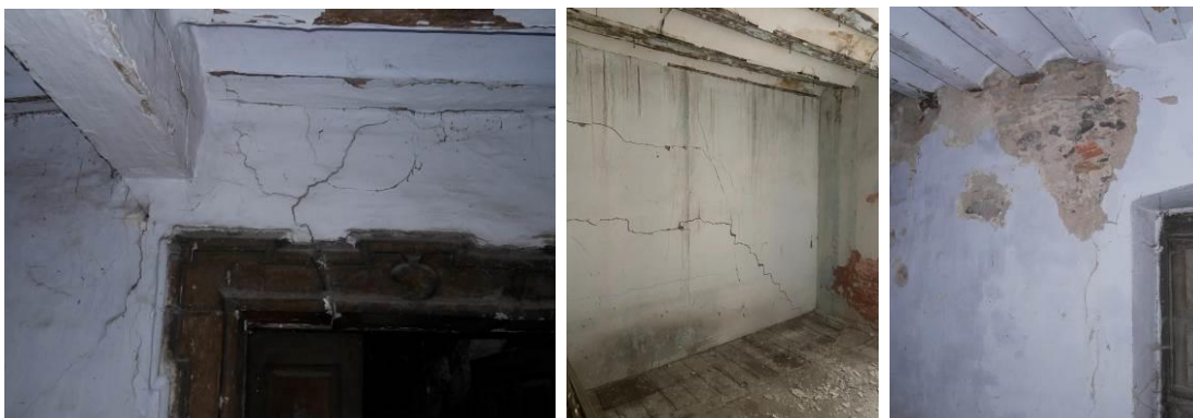
Fisuras varias en muros y tabiques, y desprendimiento de revoco
