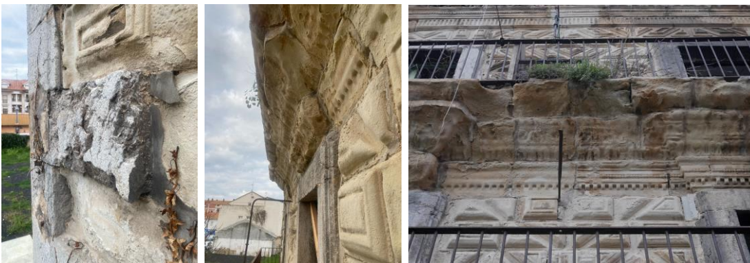
Sillares de piedra arenisca muy erosionados
