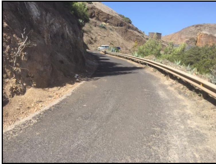
Ilustración 1 . Muestra del estado del firme en un tramo de la vía. (Fuente: Propia).
