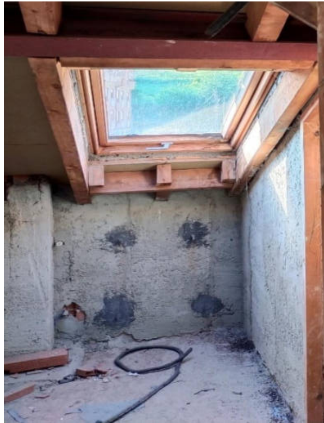
Figura 30. Detalle de pared. El edificio cuenta con canalizaciones y caja para electricidad, pero no con cableado
