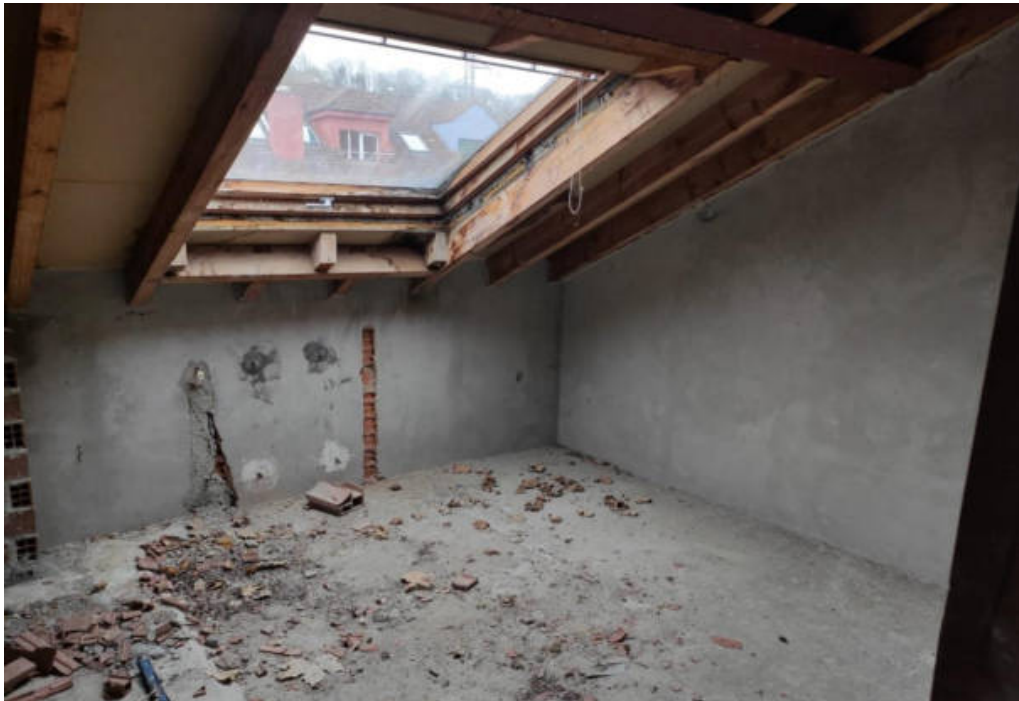
Figura 25. Habitación en bajocubierto. Se observa, debajo, el espacio preparado para colocar los radiadores 5 .
