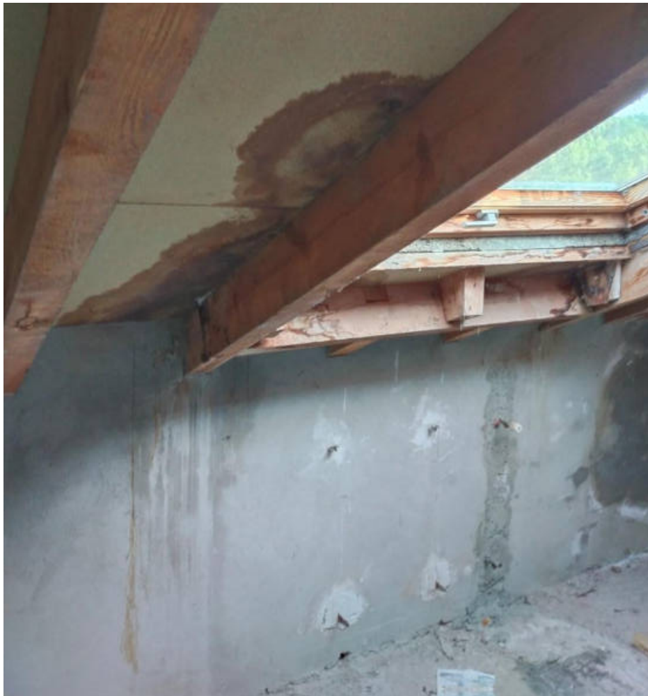
Figura 18. Gotera en la cubierta vista desde el interior del bajocubierta
