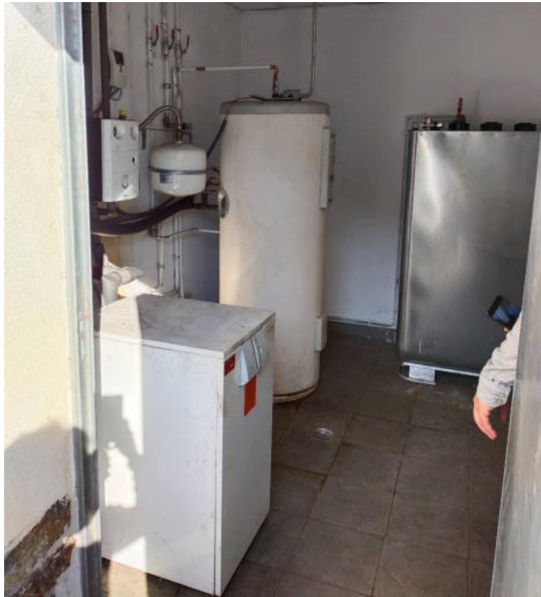
Figura 32. Sala de calderas
