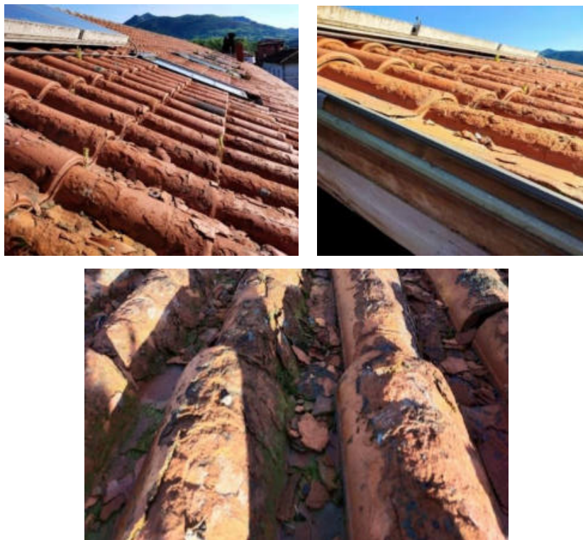
Figura 16. Detalles de la cubierta y del desgaste de las tejas
