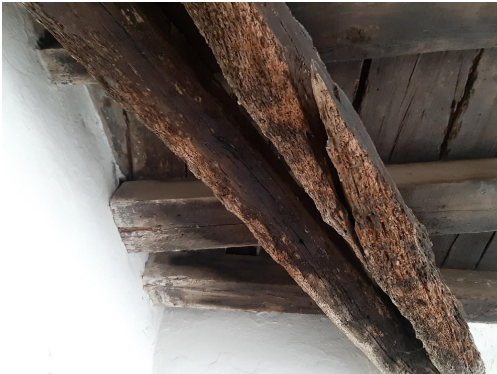
La acentuada biodegradación de la madera del rollizo ha ocasionado esta gran fractura con separación total de planos en peligro de desprendimiento .
