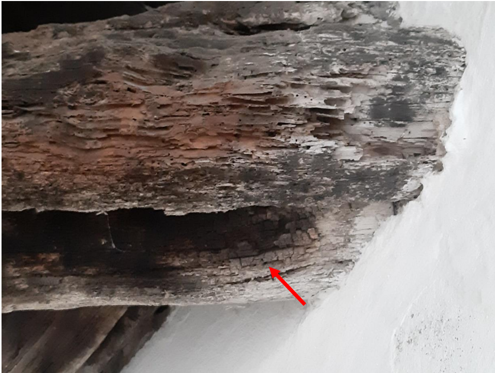
Detalle de la cabeza de uno de los rollizos donde además del deterioro y pérdida de soporte ocasionado por la carcoma, en la zona inferior se distingue la alteración por pudrición cúbica señalada con flecha roja.
