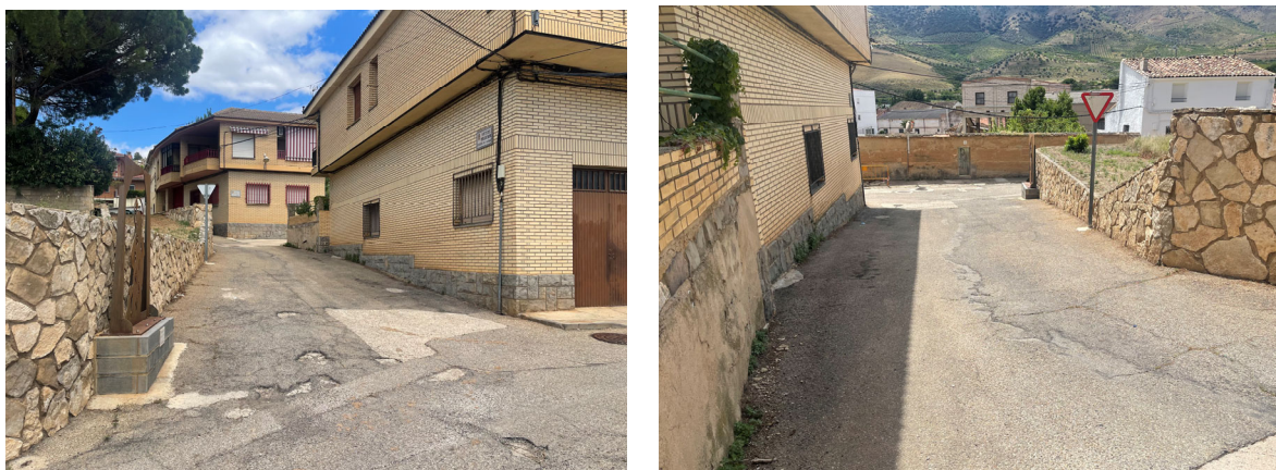
Estado del encuentro del acceso de la Calle Mayor con la Calle Matías Maluenda
