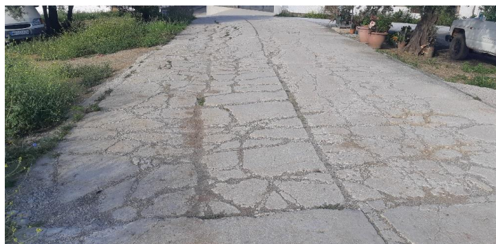
Foto 6. Zona de actuación con pavimento en muy mal estado.
