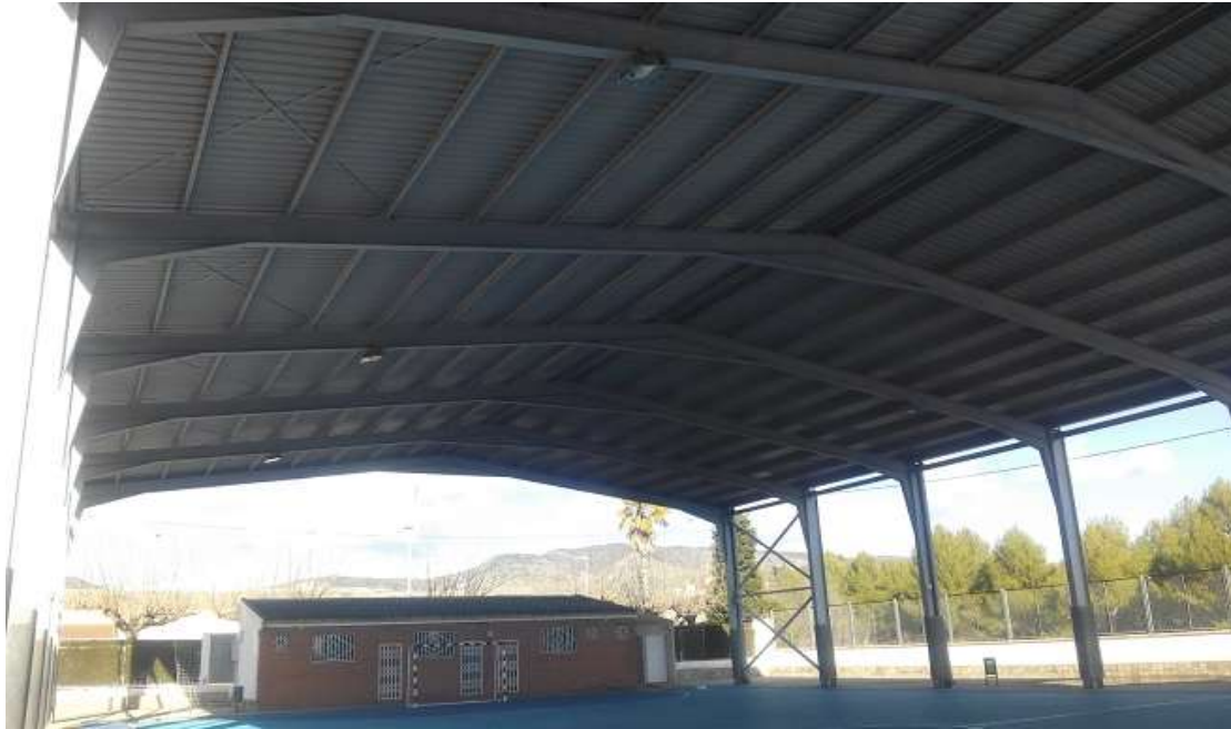
Vista general Pista Cubierta donde se observan los focos
