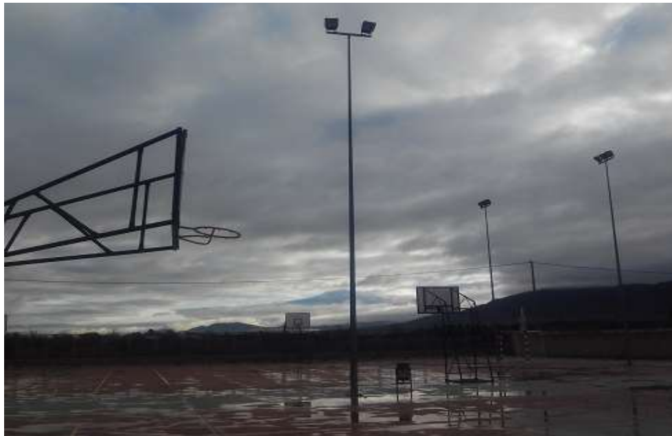
Vista pista no reglamentaria donde se aprecia uno de los dos postes
