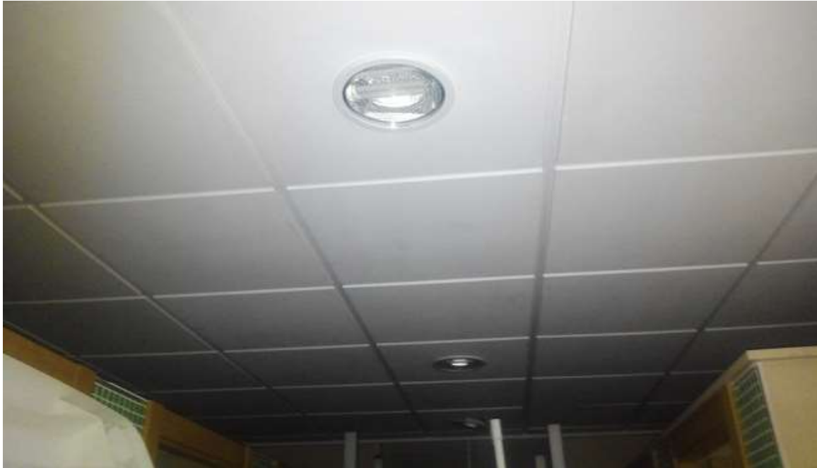
Vista de las tres luminarias tipo downlight en vestuario señoras
