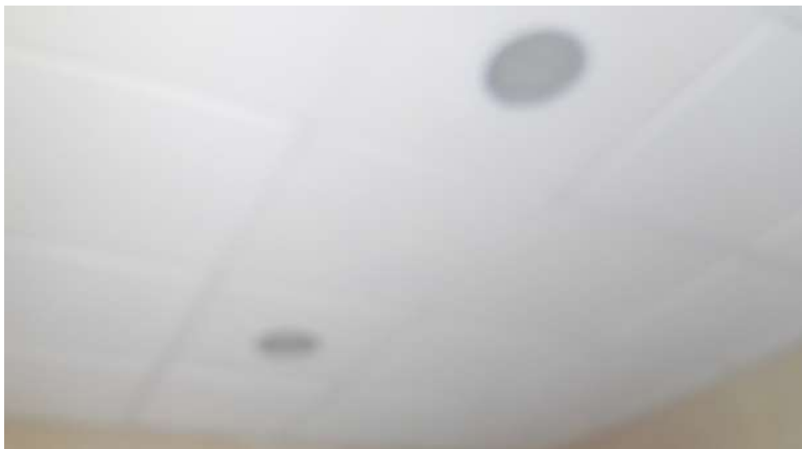
Vista de las 2 Luminarias de entrada al Pabellón (Gimnasio)
