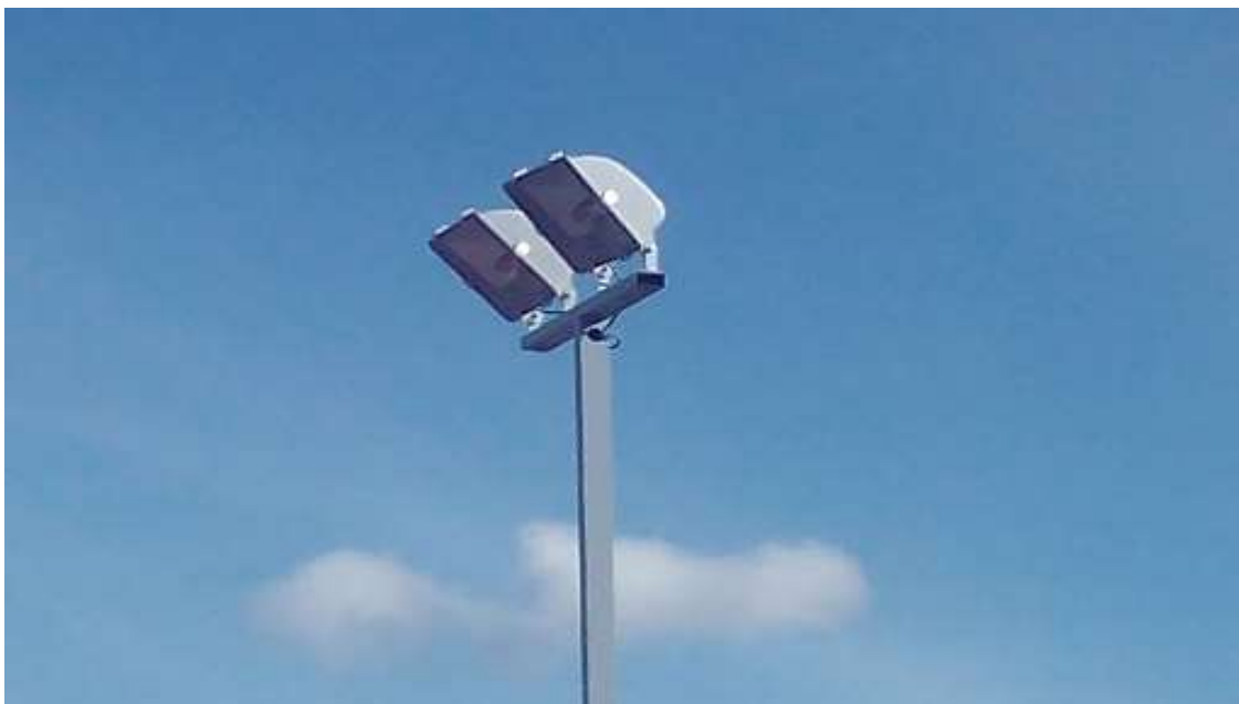
Detalle poste con dos focos Pista de Pádel
