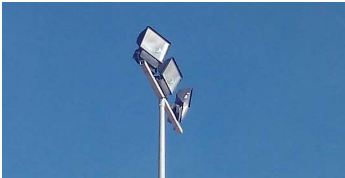
Detalle torre de tres Focos Pista de Baloncesto
