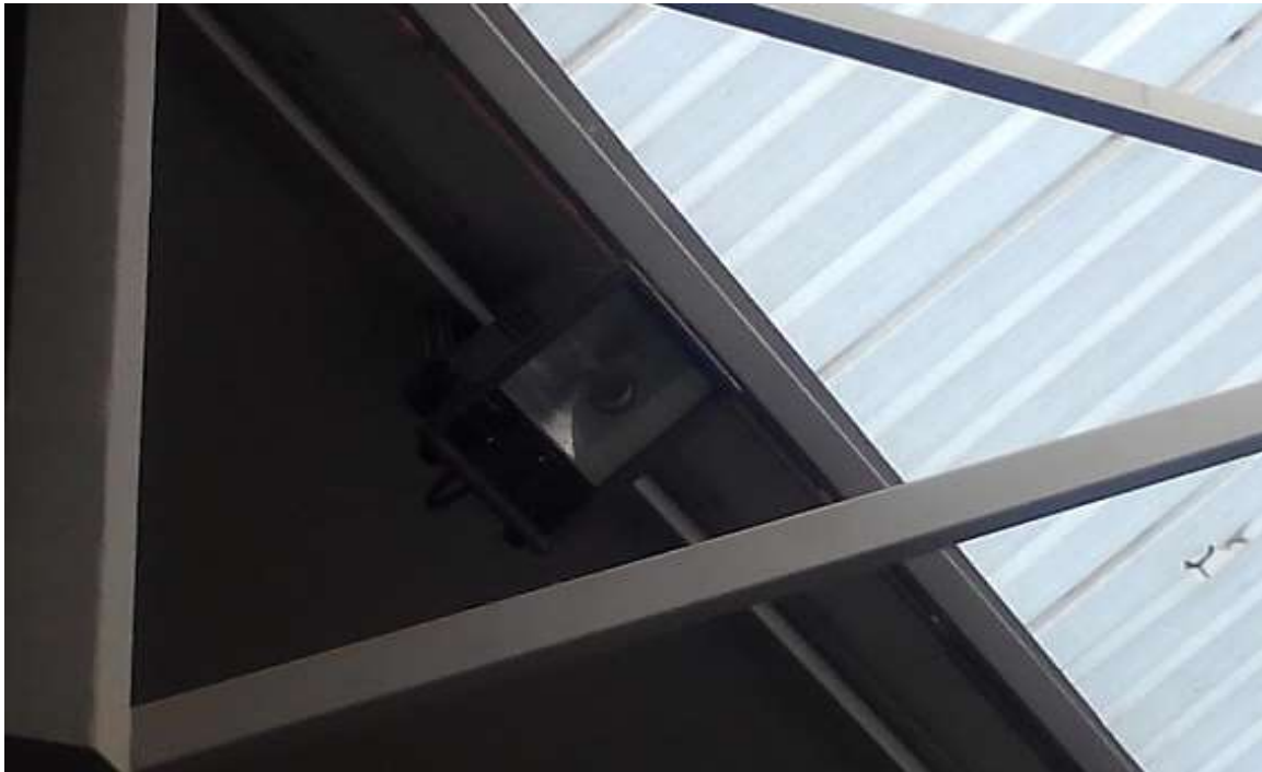
Detalle Foco Gimnasio
