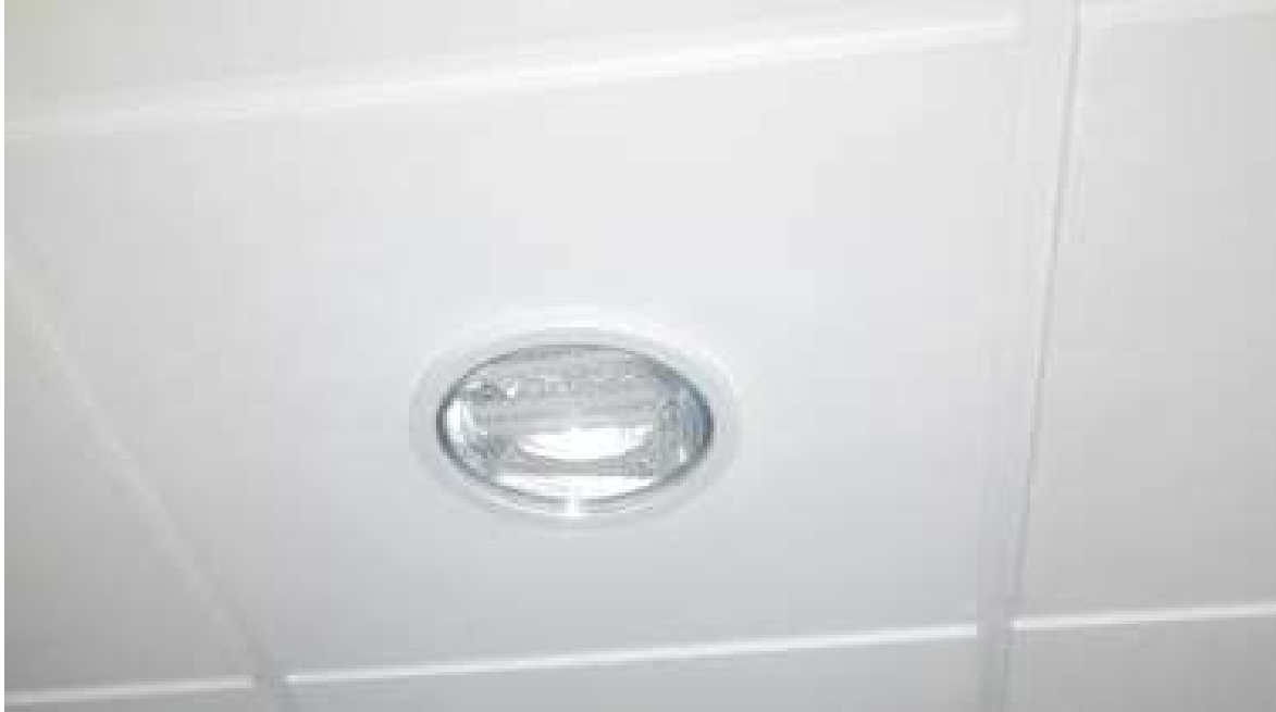
Vista detalle de la Luminaria existente en la Sauna
