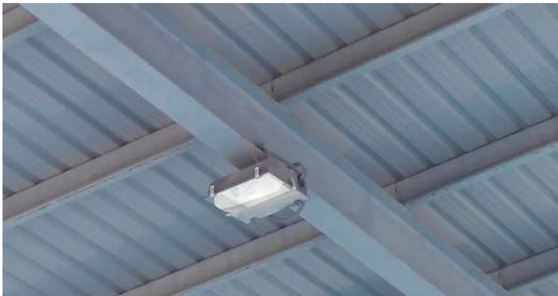
Detalle Focos Pista Cubierta
