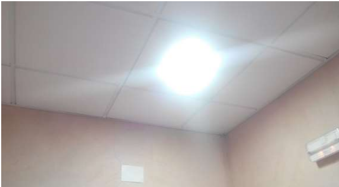
Vista luminaria tipo downlight entrada vestuario
