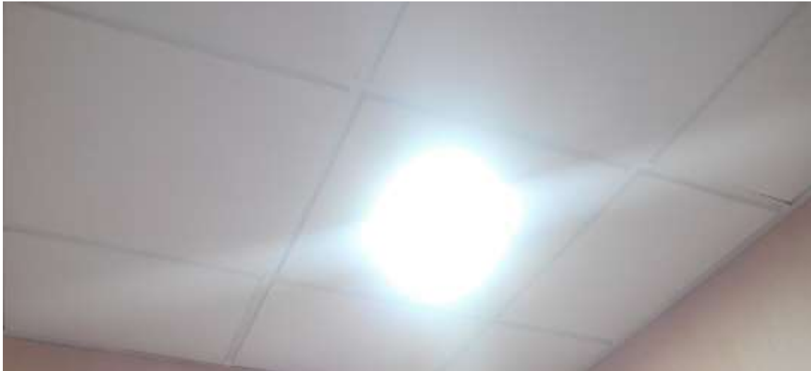
Detalle luminaria tipo downlight en la entrada a vestuarios piscina
