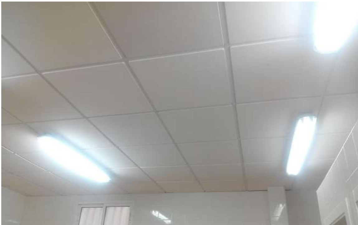
Vestuario de caballeros, se observan 3 de las 4 pantallas existentes
