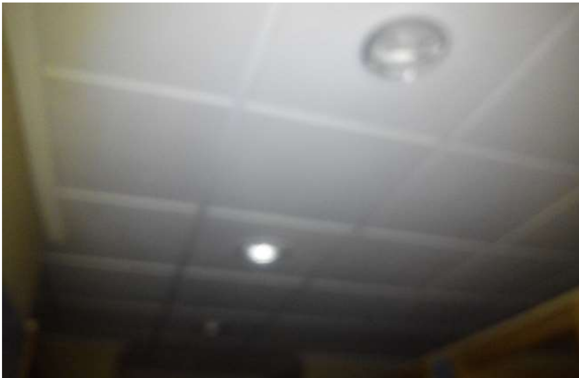
Vista de las tres luminarias tipo downlight en vestuario caballeros
