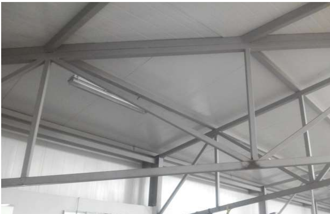
Vista de una de las cinco pantallas de dos tubos fluorescentes en Cubierta Gimnasio
