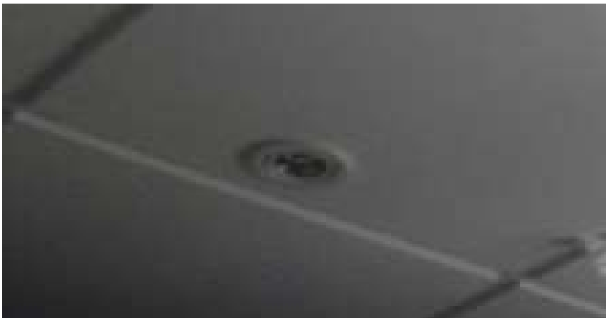
Detalle de 1 de los 13 halógenos existentes en los vestuarios de la piscina (7 en la zona de caballeros y 6 en la de señoras)
