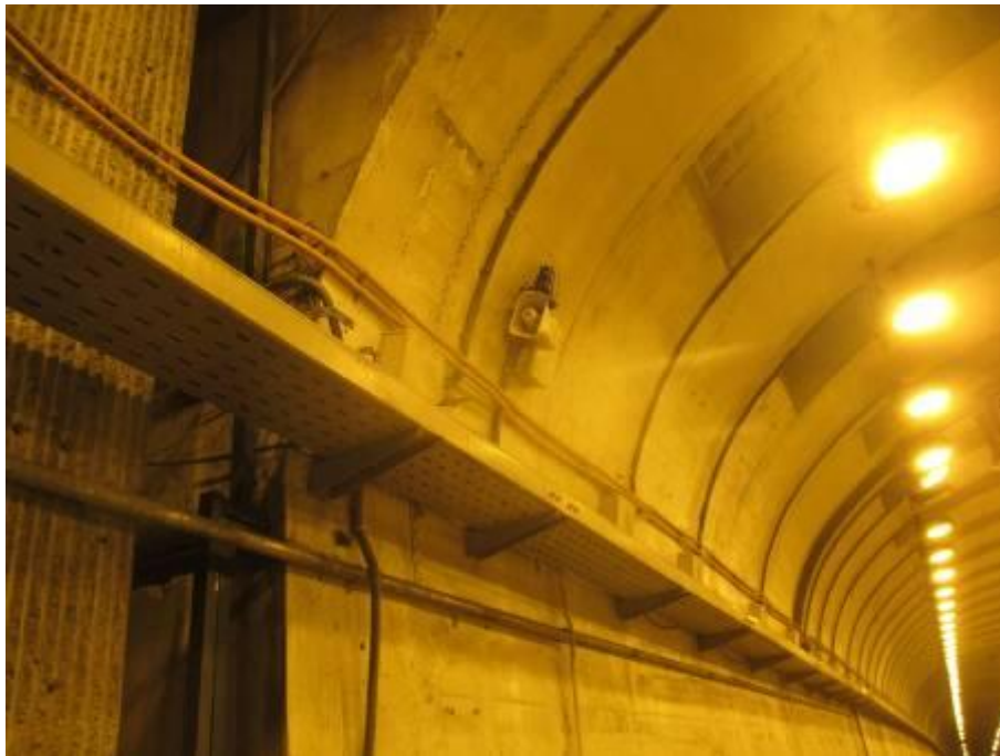
Imagen 7 : Alarma y cables en la obra
