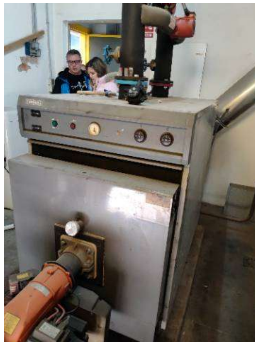
Ilustración 4 Imagen de caldera
