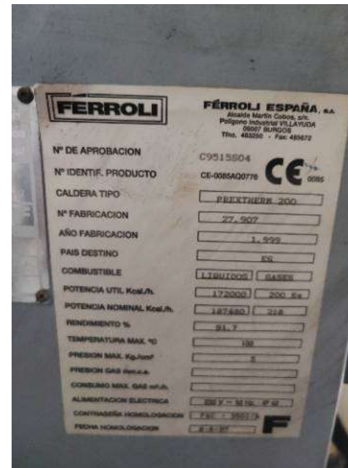
Ilustración 5 Placa de características de la caldera
