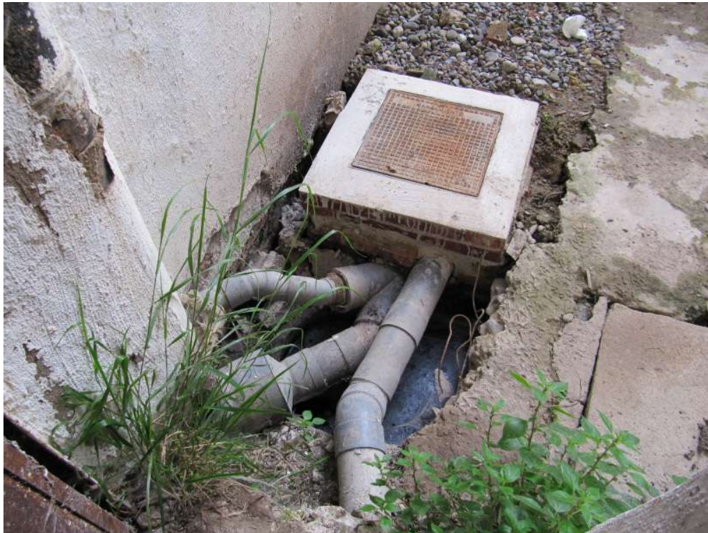
SANEAMIENTO ENTERRADO PLANTA BAJA (foto cedida por el ayuntamiento de Logroño)
