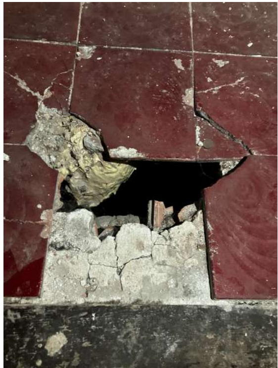
DETALLE DERRUMBE MESETA ESCALERA
