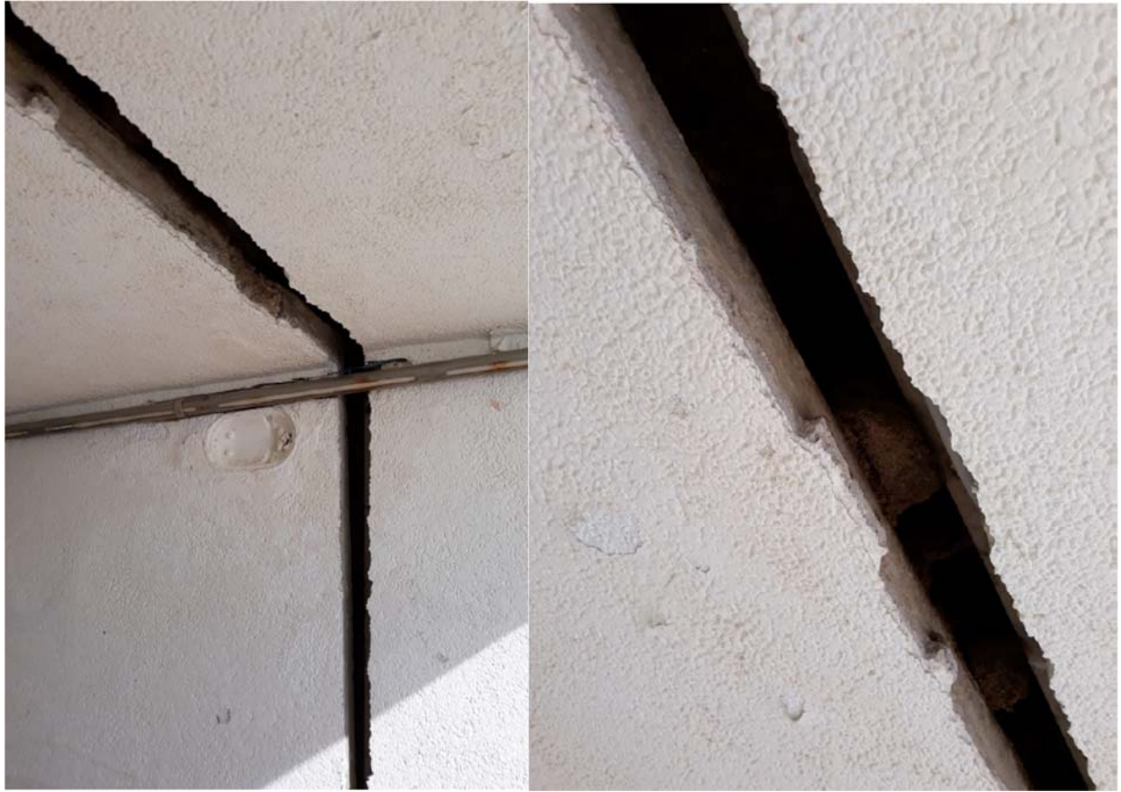
Detalle de la grieta producida por el movimiento del último cajón
