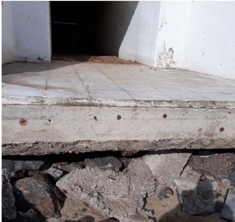
Perdida de apoyo de la losa
