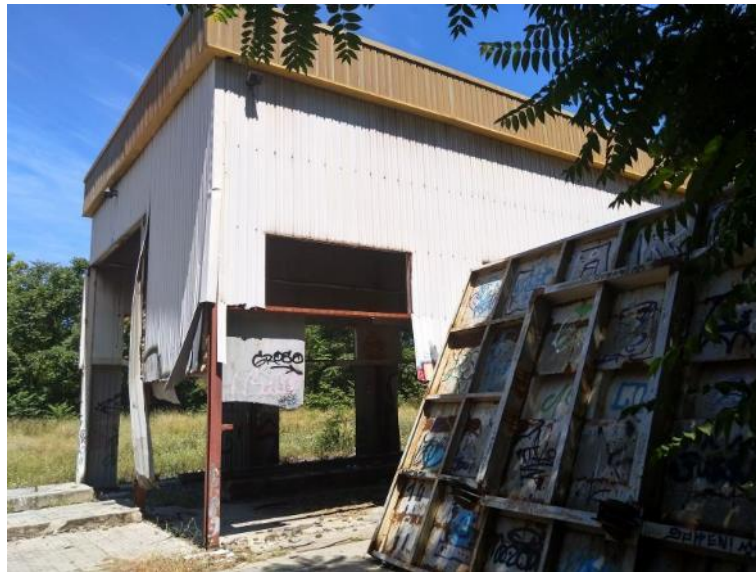
Imagen 39. Aljibe de la instalación vandalizado
