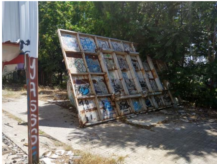
Imagen 22. Aljibe de la instalación vandalizado
