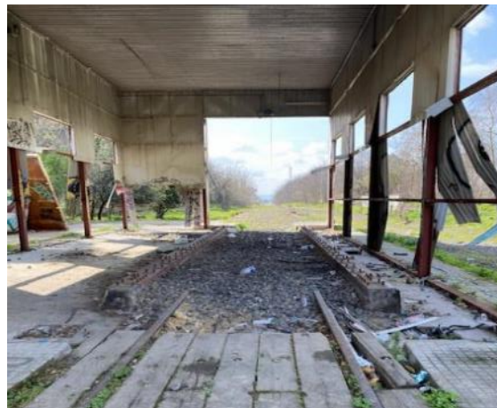
Imagen 12. Vista del estado actual de la nave envolvente del Cambiador de Córdoba.
