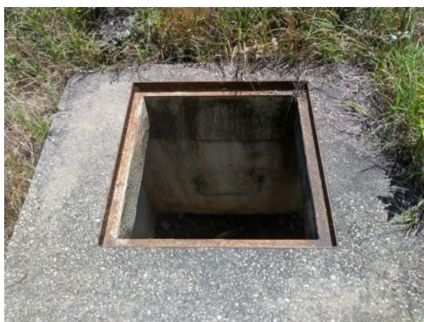
Imagen 47. Calce descarrilador con llave Bouré que da acceso a la derivación
