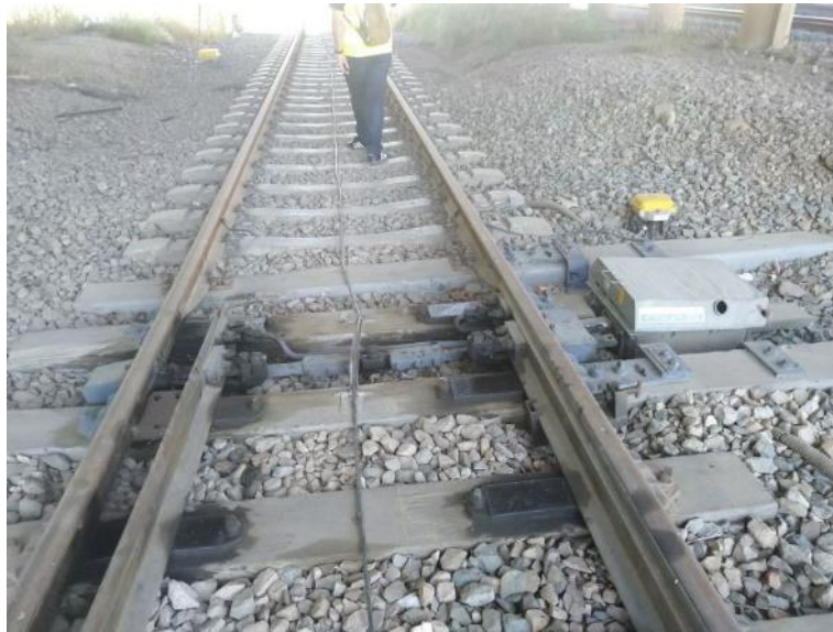
Imagen 49. Desvío tipo C existente del culatón del cambiador
