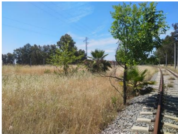
Imagen 51. Discontinuidad del carril
