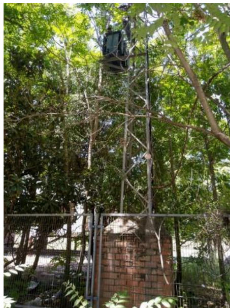
Imagen 16. Transformador de baja tensión existente en la instalación
