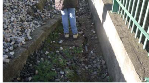
FOTO 7. Desplazamiento en base cerramiento.
