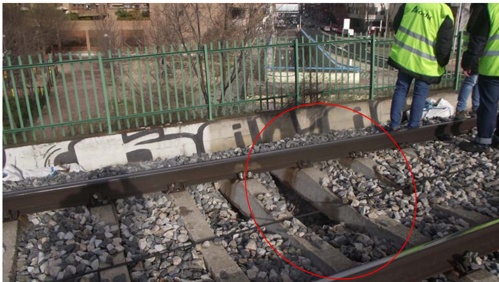
FOTO 5. Descalce en centro de vía 2, alineado con socavón y dirección de túnel.
