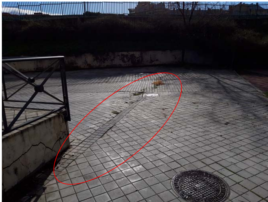
FOTO 10. Zona entre boca de túnel y terraplén de ADIF con línea de fractura y baches en pavimento
