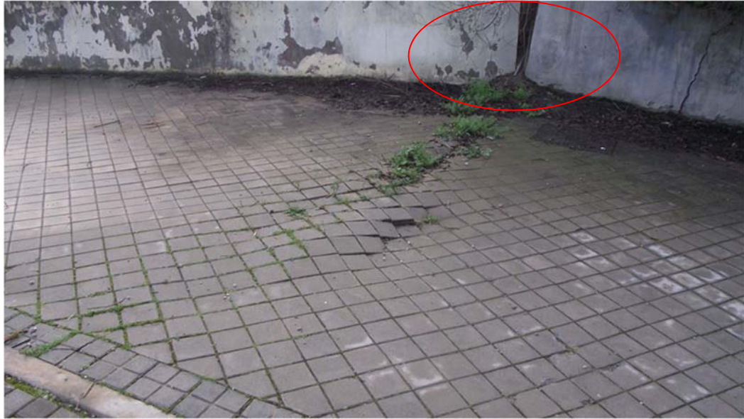
FOTO 9. Apertura de junta en muro de contención de pie de terraplén. Baches en pavimento.
