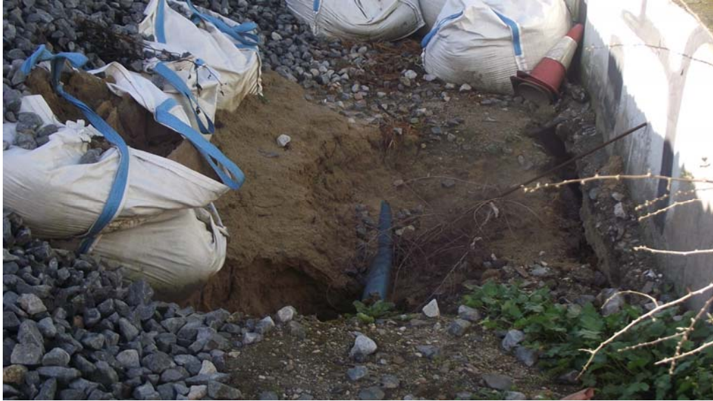
FOTO 2. Situación de socavón entre pie de banqueta de balasto y muro de cerramiento con grieta de desplazamiento de la cimentación.
