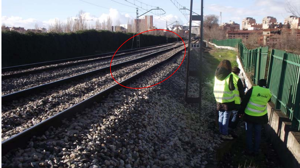
FOTO 4. Bache en vía 2 a la altura de descalce de traviesas y socavón.
