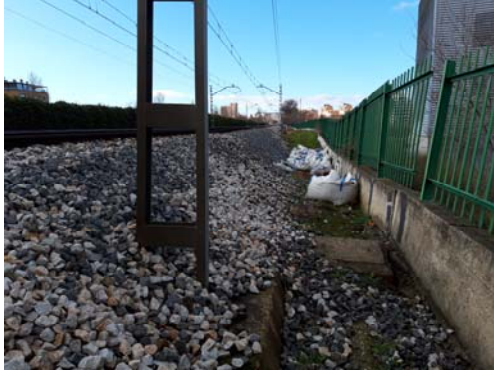
FOTO 6. Desplome de cerramiento.
