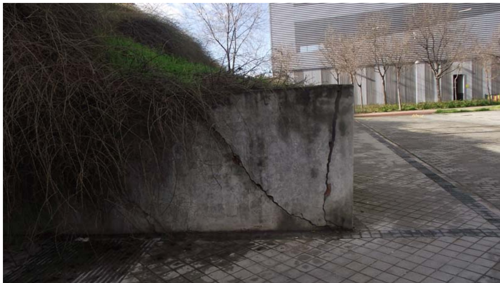
FOTO 8. Grietas en zona frontal de muro de pie de terraplén.
