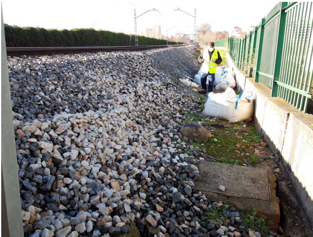
FOTO 3. Agente de Mantenimiento de ADIF situado en punto de socavón.
