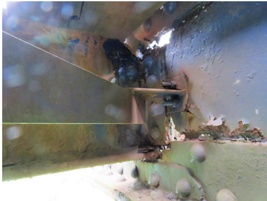
Imagen 15. Perforaciones en unión larguero–vigueta. (Estado actual)
