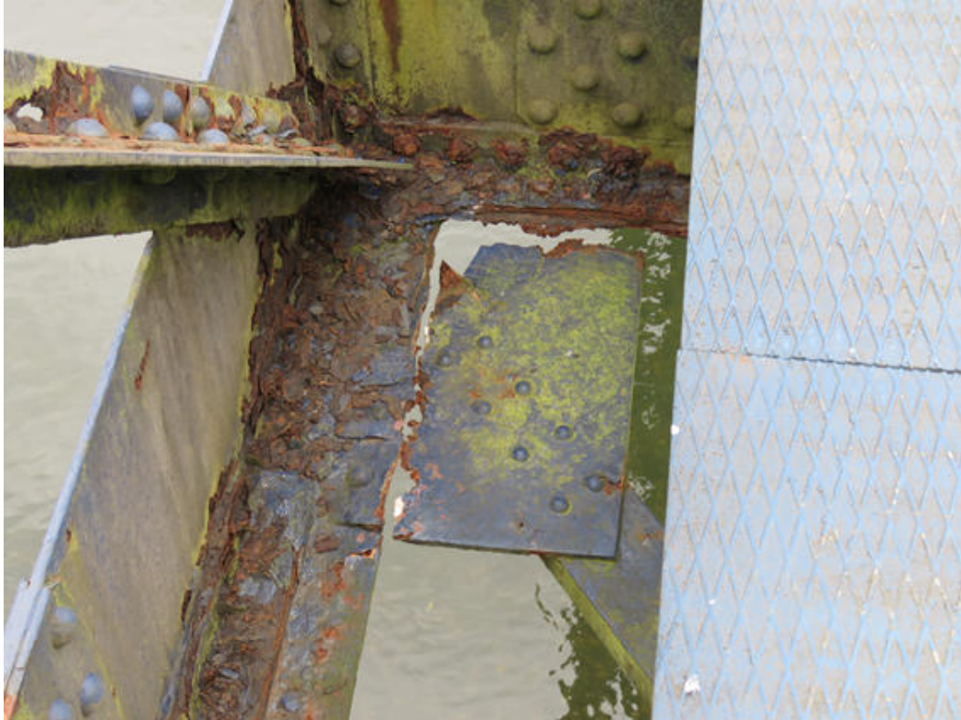
Imagen 18. Pérdida de sección completa de la cartela de unión del arriostramiento contraviento inferior con la viga principal. (Estado actual)
