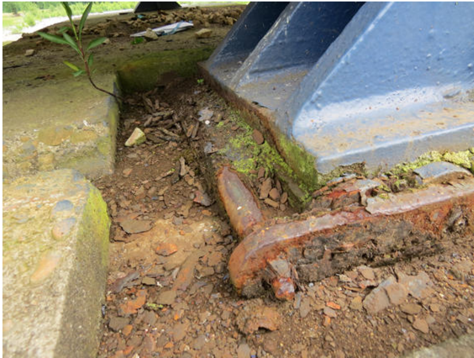
Imagen 19. Corrosión generalizada y encastramiento del apoyo móvil del estribo 1. (Estado actual)
