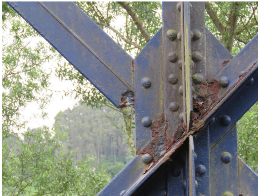
Imagen 14. Pérdida de sección en nudo de diagonales. (Estado actual)
