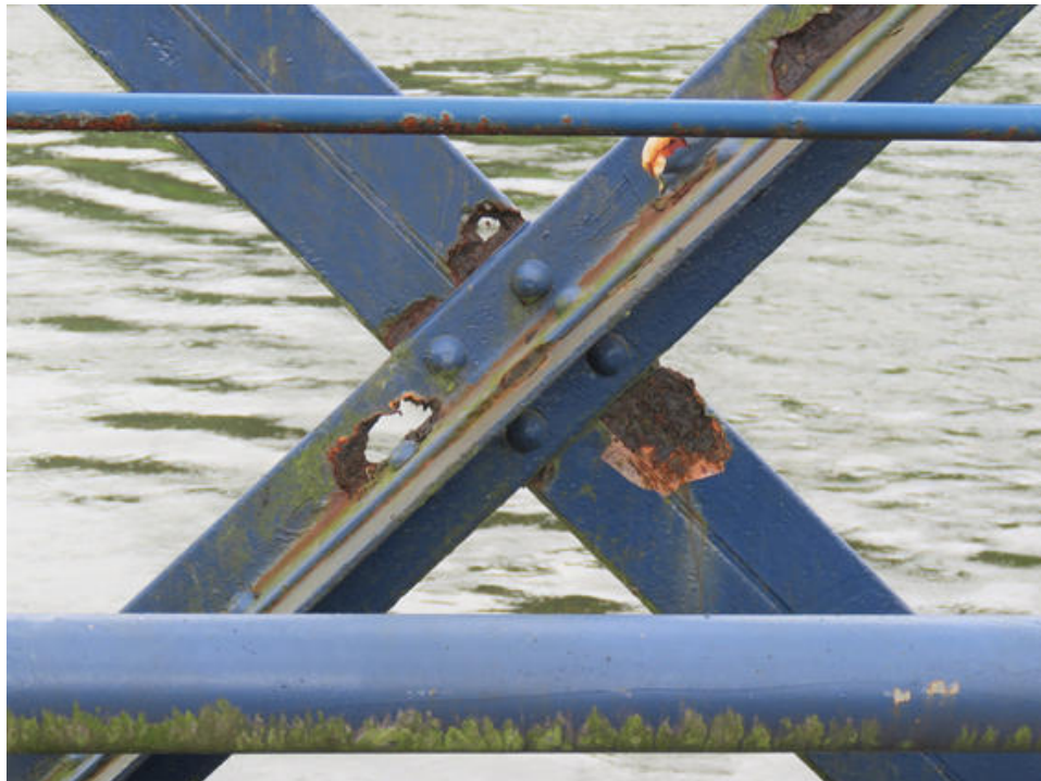
Imagen 13. Perforaciones en diagonales. (Estado actual)
