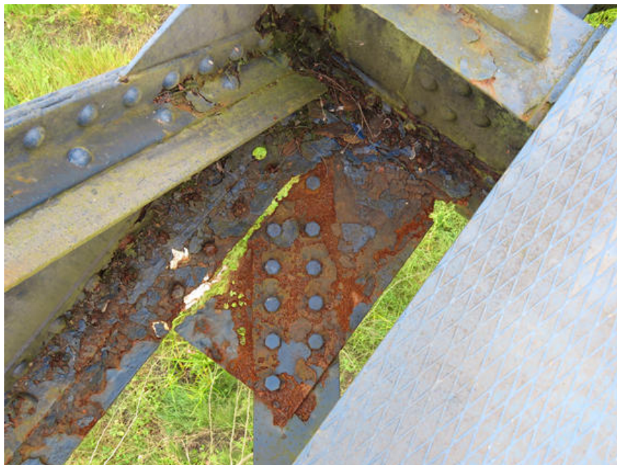
Imagen 17. Pérdida de sección y perforaciones en cartelas. (Estado actual)
