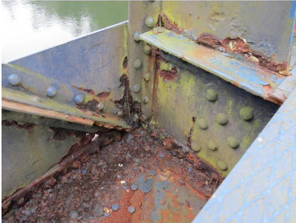
Imagen 12. Perforaciones en contactos cordón inferior – diagonal y contacto del faldón con el ala del cordón inferior. (Estado actual)
