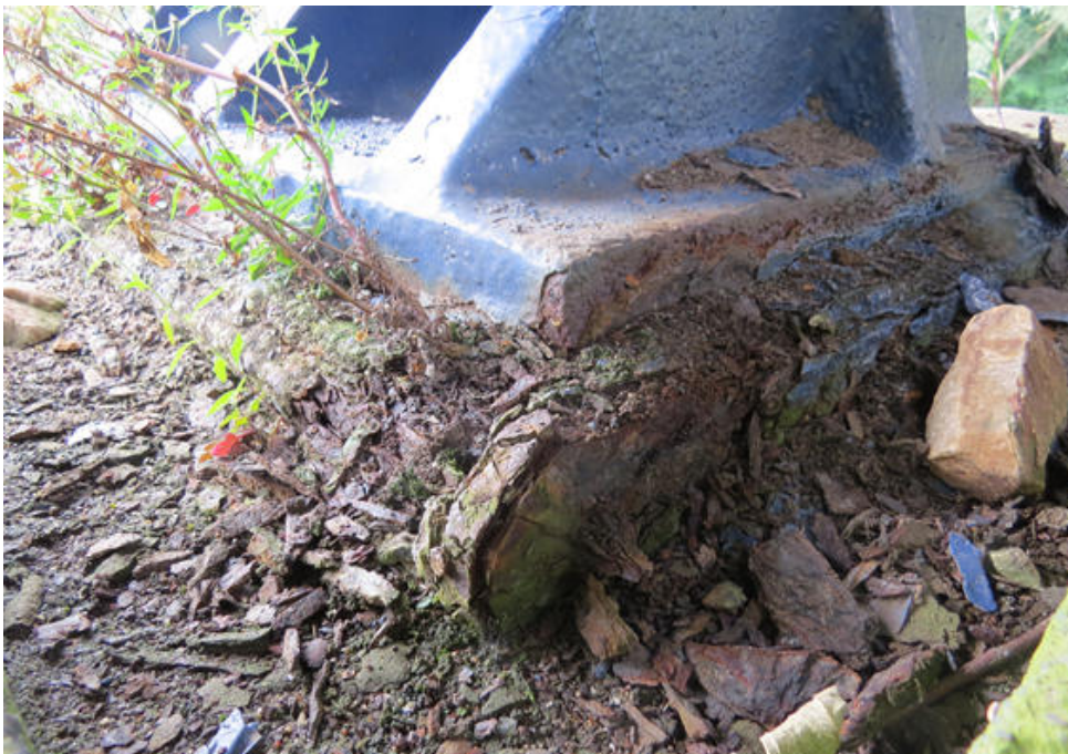
Imagen 20. Corrosión generalizada y encastramiento del apoyo móvil de la pila 1. (Estado actual)
