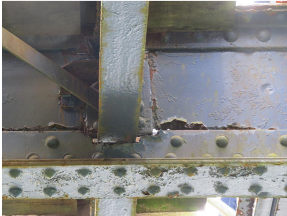
Imagen 16. Perforaciones severas en unión larguero-vigueta. (Estado actual)
