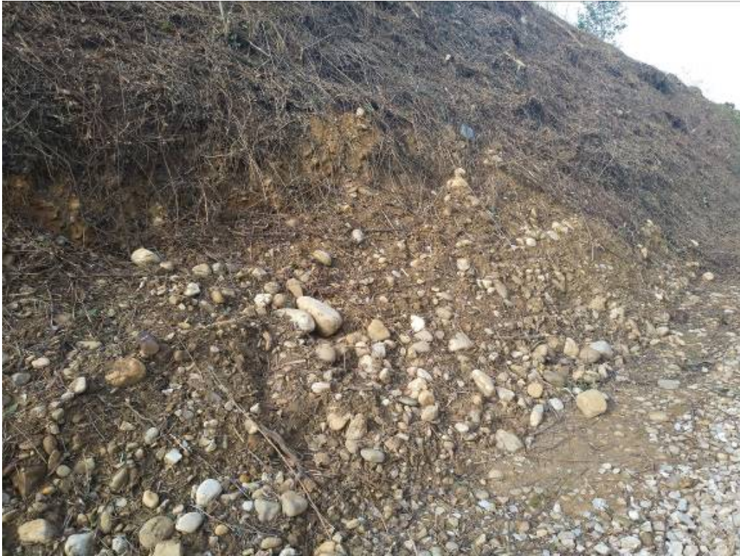
Zona con material suelto en el talud izquierdo, alrededor del pk 4/350.
