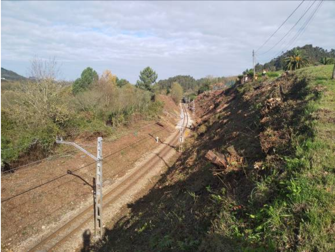
Imagen general de la trinchera afectada por el desprendimiento. Se ha realizado una tala y la corta y siega de vegetación para eliminar peso y poder realizar una revisión del terreno.
