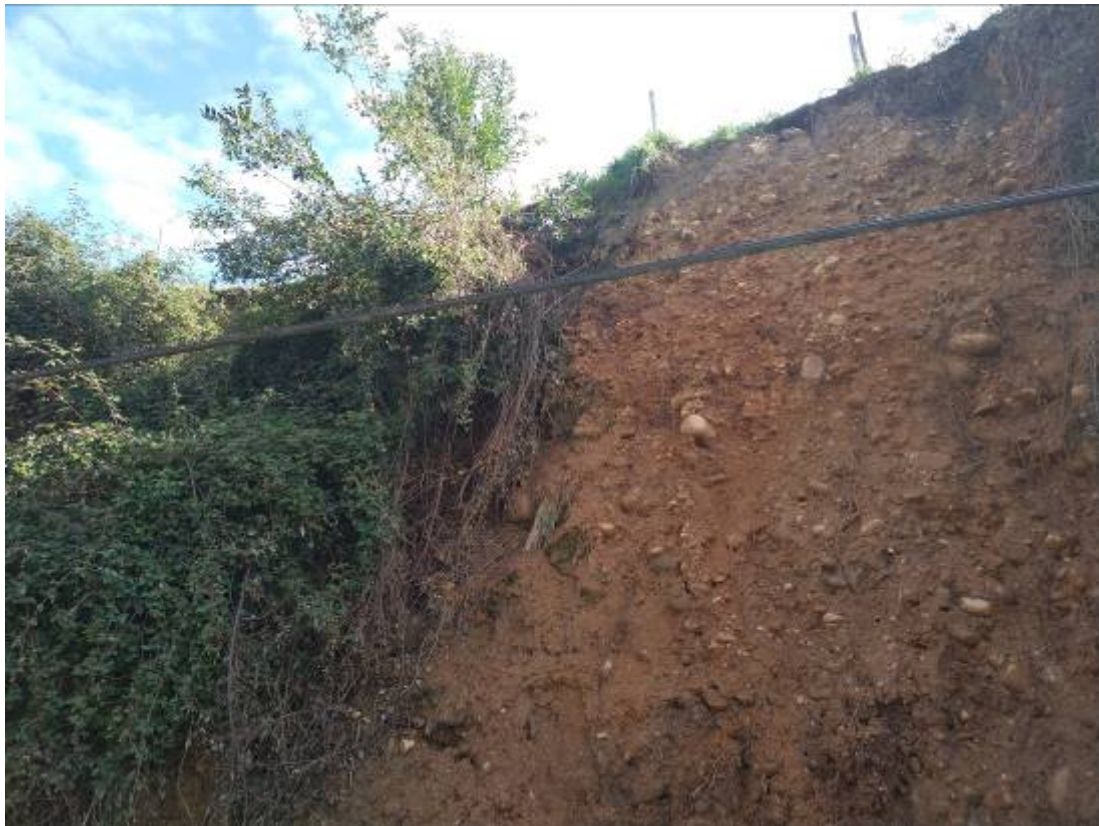
Desprendimiento en el pk 4/500
