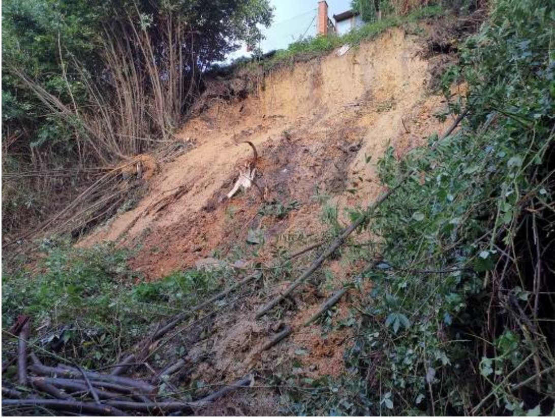
Otra imagen de la zona del desprendimiento. Arriba se observa un murete de cierre y una edificación cercana al borde superior del talud.
