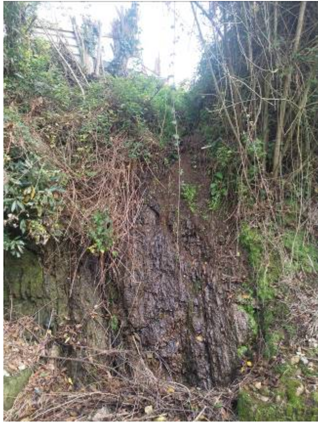
Zona de caída descontrolada de aguas por el talud.
