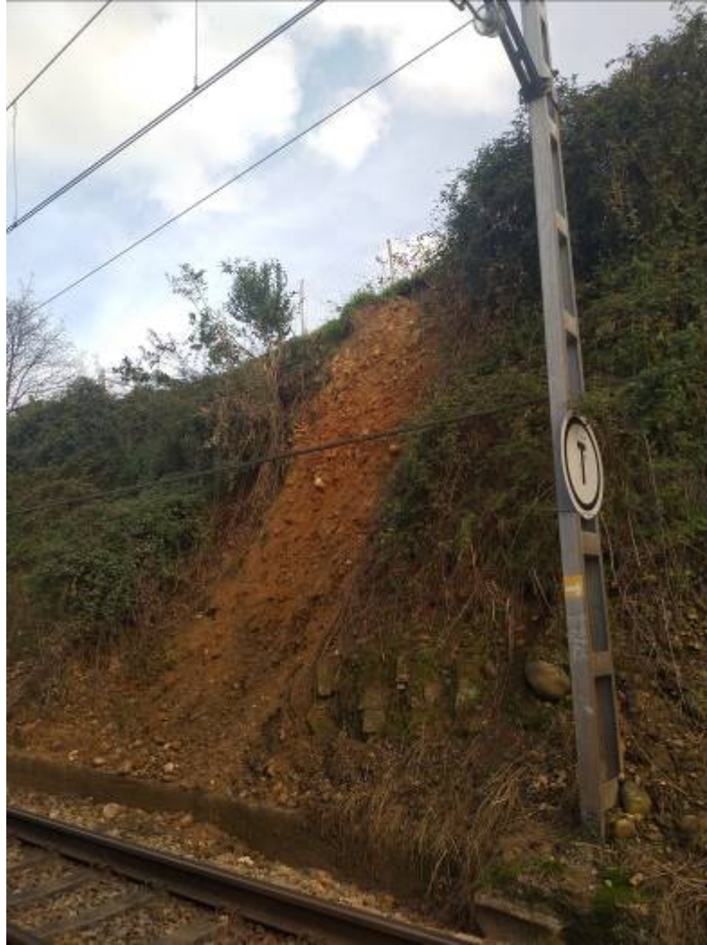
Desprendimiento en el pk 4/535
