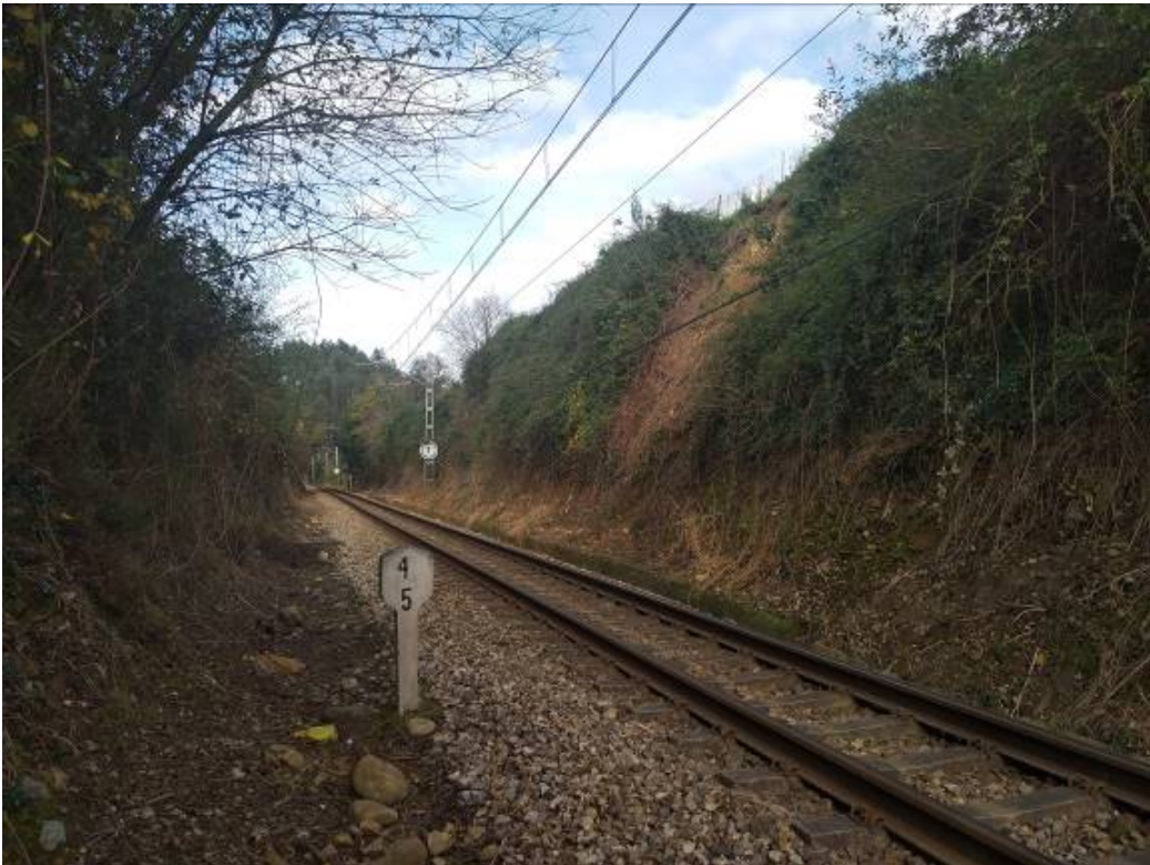
Zona de desprendimiento en el entorno del pk 4/500. Aquí no se ha realizado tratamiento de vegetación.
