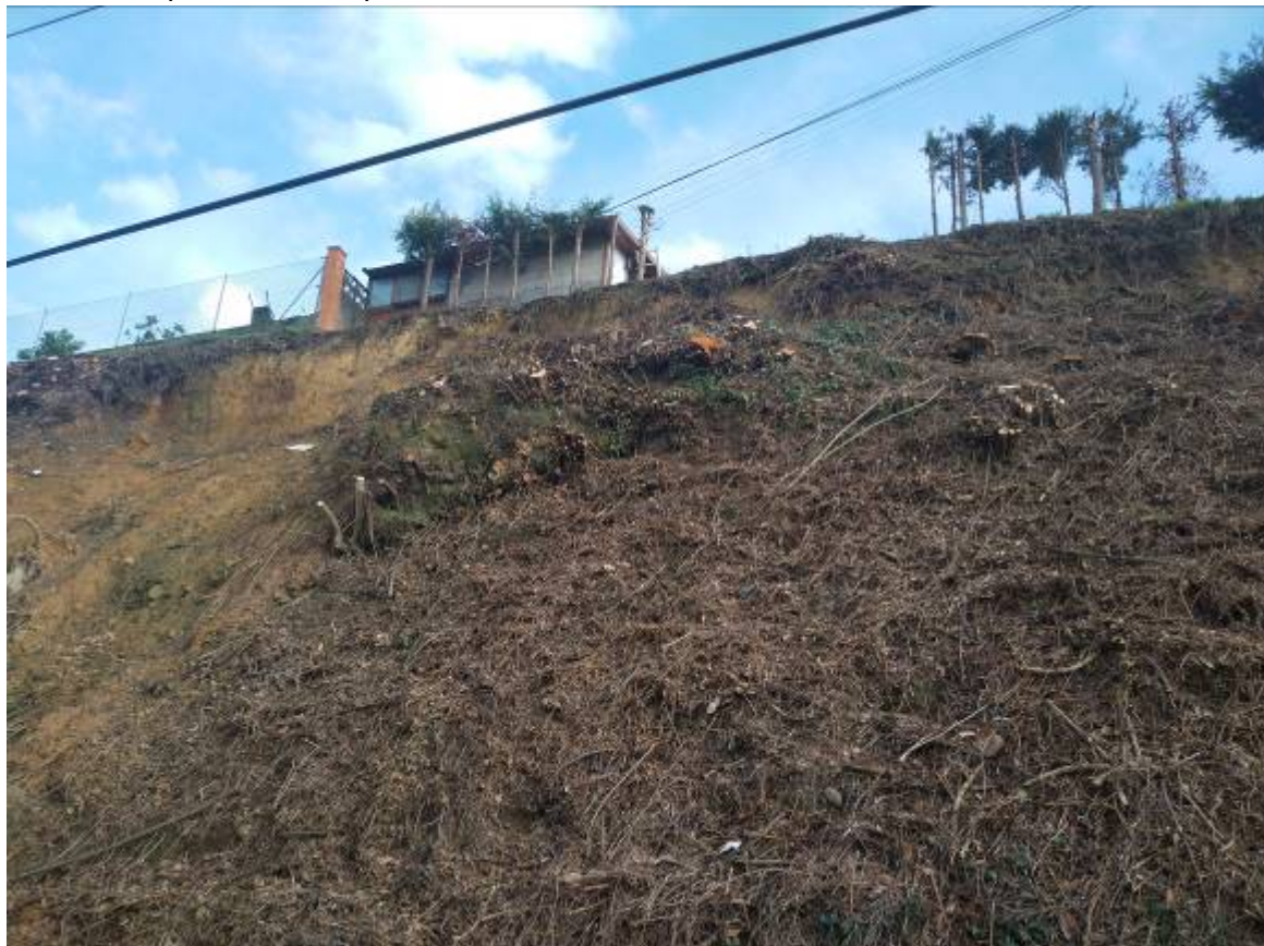
Zona con material desprendido que presenta riesgo de caída hacia la plataforma de la vía.
