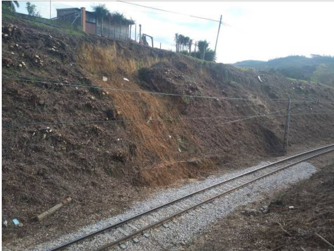
Zona del desprendimiento. Se observa la cercanía de la edificación y la presencia de varias bolsas de material desprendido susceptible de caer hacia la vía.
