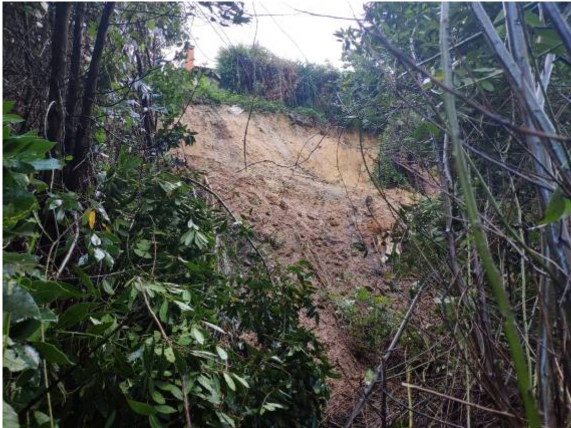
Imagen de la zona del desprendimiento tras el accidente. Se observa el escarpe del desprendimiento y la abundante vegetación existente en el talud.
