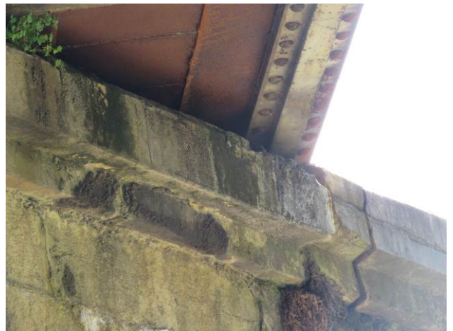
Imagen 33. Apoyo sobre pila con sillar de apoyo roto
