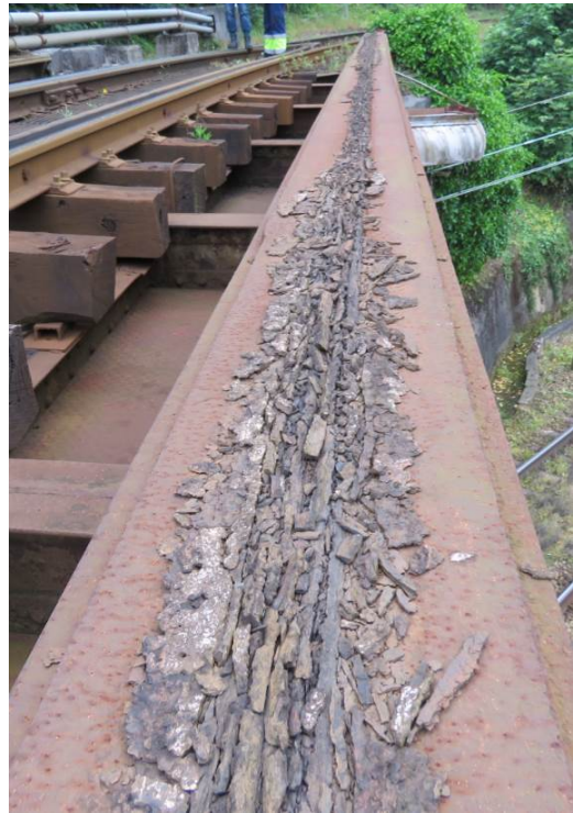
Imagen 6. Corrosión ala superior de vigas
