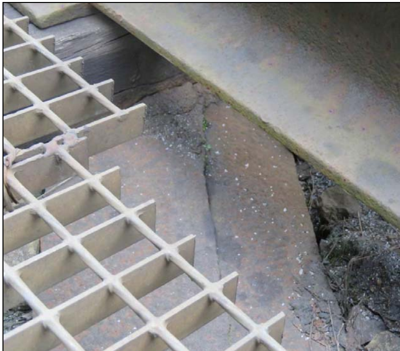
Imagen 19. Rotura de ala superior de vigueta de borde
