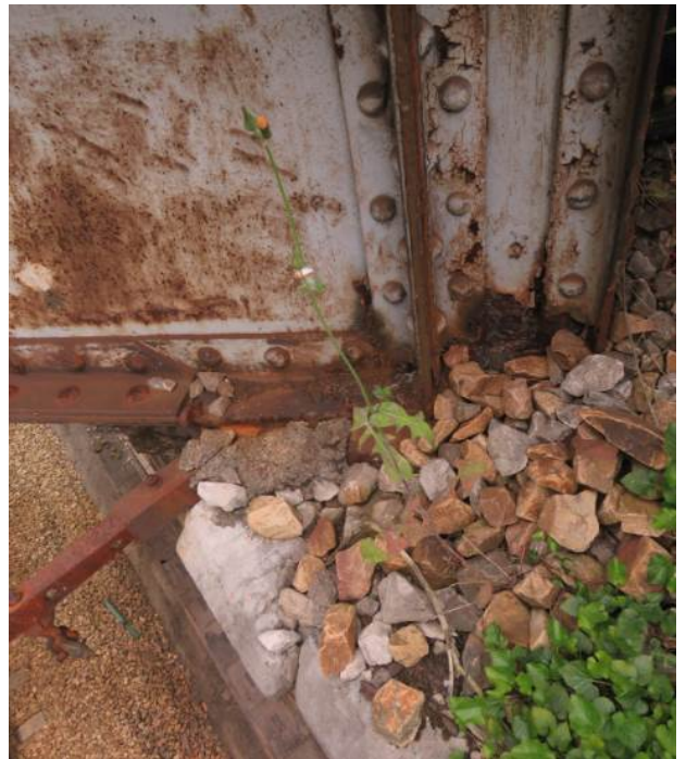
Imagen 27. Apoyo Estribo lado Mieres con sillar de apoyo roto y parcialmente desprendido
