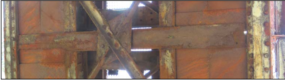
Imagen 14. Perdidas de sección, perforaciones de ala inferior de viguetas y pérdida de roblones
