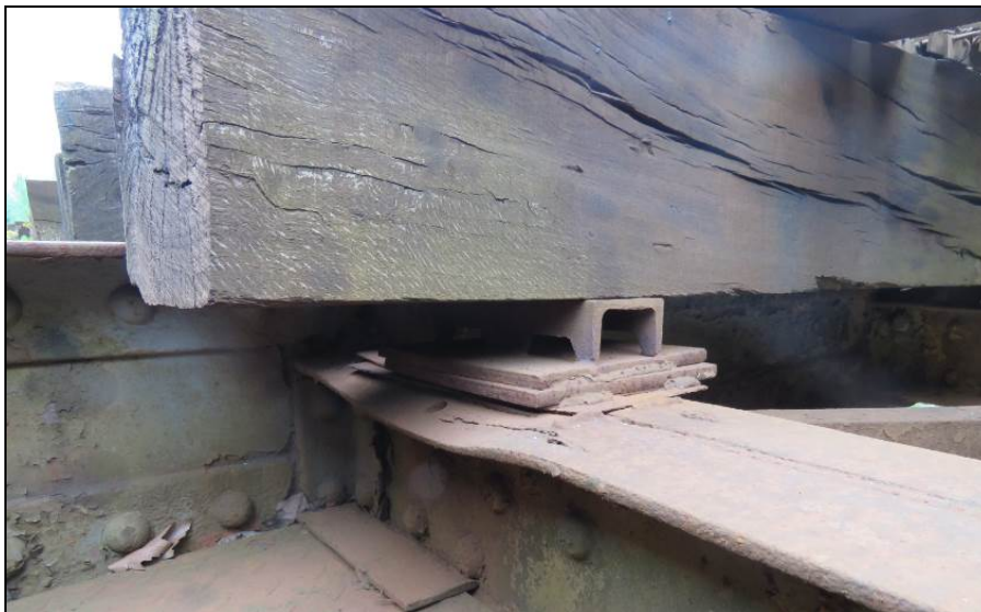
Imagen 17. Deformaciones y grietas en ala superior de larguero
