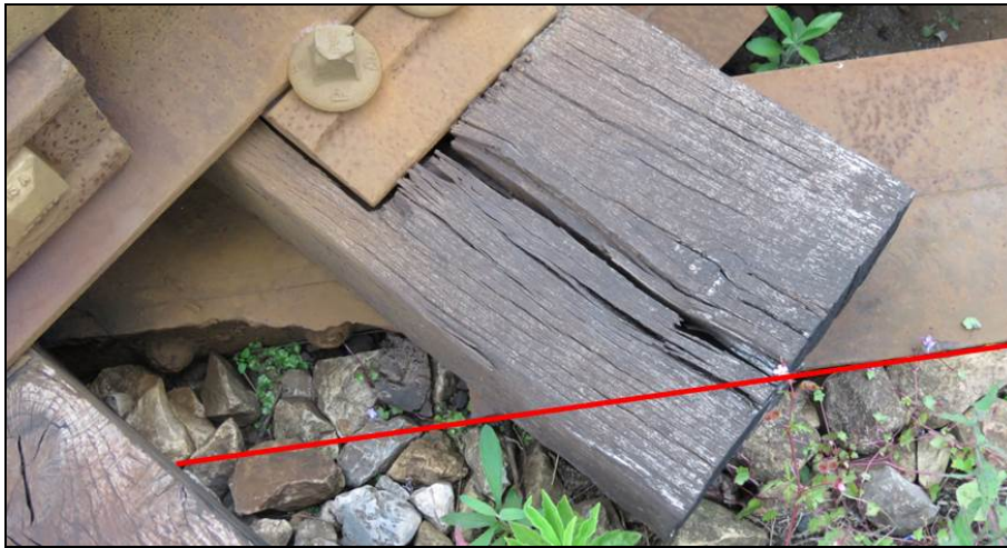
Imagen 15. Rotura parcial de ala superior de vigueta de borde
