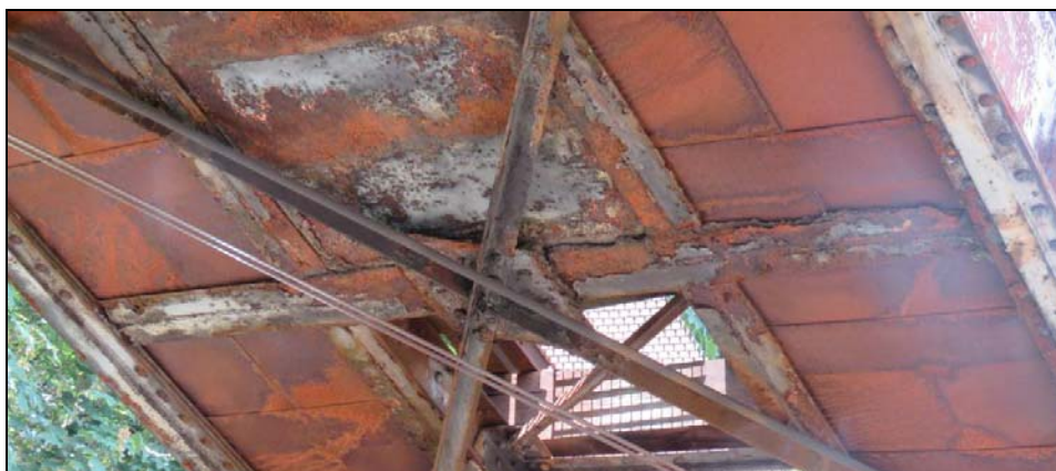
Imagen 13. Pérdida de sección generalizada en ala inferior de vigueta
