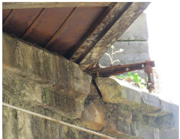
Imagen 29. Deficiente apoyo del vano sobre el estribo lado Mieres
