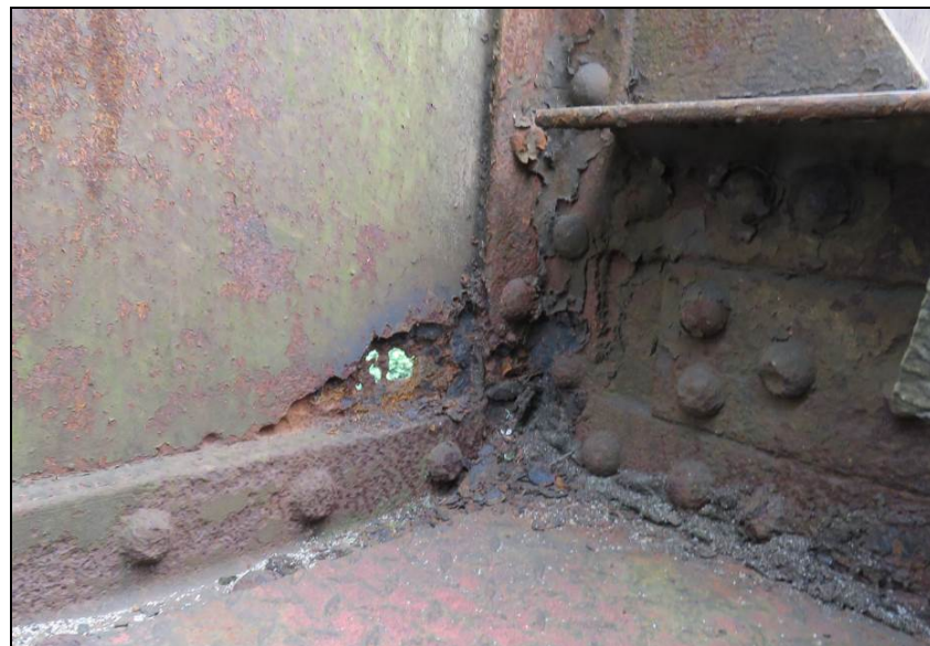
Imagen 9. Corrosión hasta perforación en parte inferior del alma de viga en los encuentros con las viguetas.
