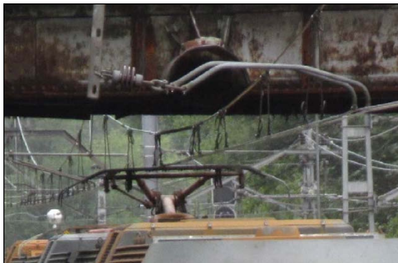
Imagen 36. Detalle de la comprometida situación de la catenaria y el tablero metálico
