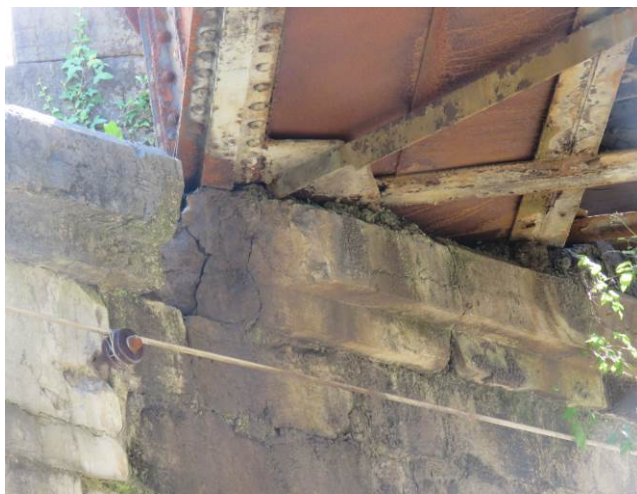
Imagen 28. Deficiente apoyo del vano sobre el estribo lado Mieres
