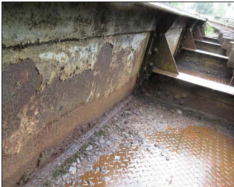
Imagen 7. Corrosión con pérdida de sección en parte inferior del alma
