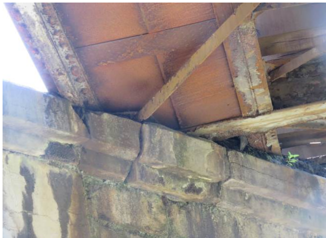
Imagen 32. Apoyo sobre pila con sillar de apoyo roto y sueltos
