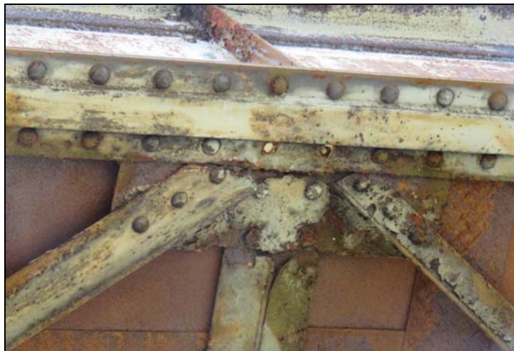
Imagen 12. Pérdida de roblones en la cartela de unión arriostramiento contraviento - viga
