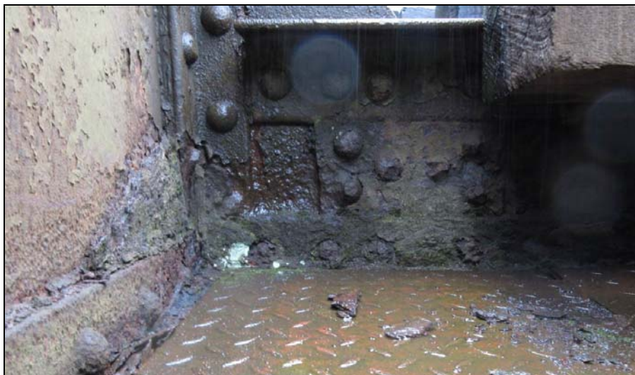
Imagen 10. Corrosión en unión vigueta – viga
