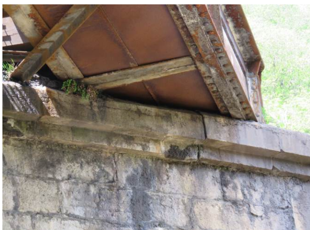
Imagen 34. Apoyo sobre pila con sillar de apoyo desplazado
