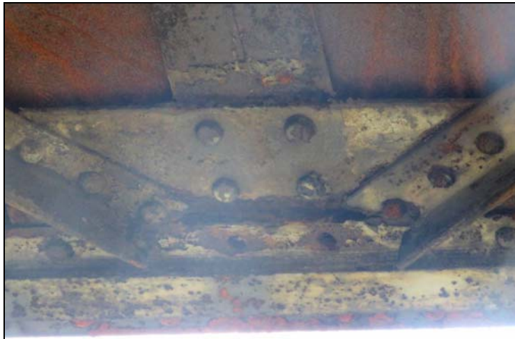
Imagen 11. Pérdida de roblones en la cartela de unión arriostramiento contraviento - viga
