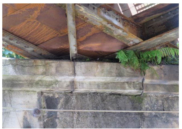
Imagen 31. Apoyo estribo lado Ablaña con sillar de apoyo suelto
