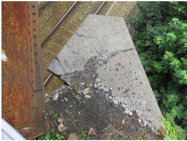
Imagen 26. Apoyo Estribo lado Mieres con sillar de apoyo roto y parcialmente desprendido, deficiente apoyo del tablero
