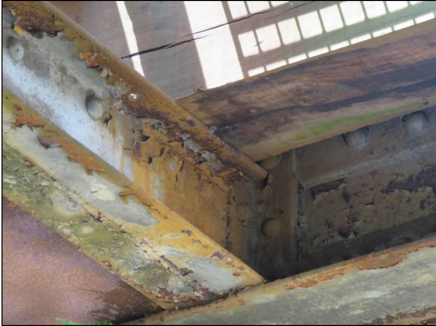
Imagen 16. Fisura de ala superior de larguero
