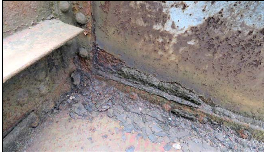
Imagen 8. Corrosión hasta perforación en parte inferior del alma de viga en los encuentros con las viguetas.
