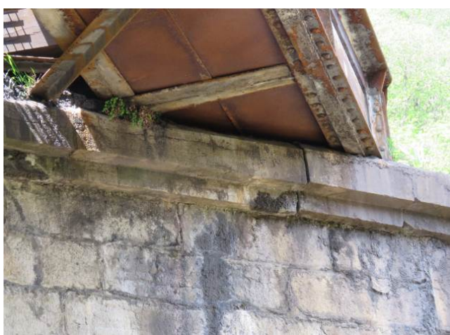
Imagen 30. Apoyo sobre pila con sillar de apoyo desplazado
