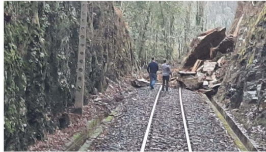
La vía cortada por el desprendimiento.
