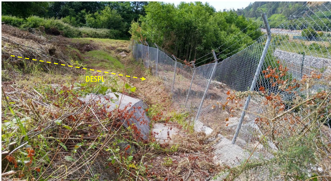
Desplazamiento de la cuneta de coronación.
