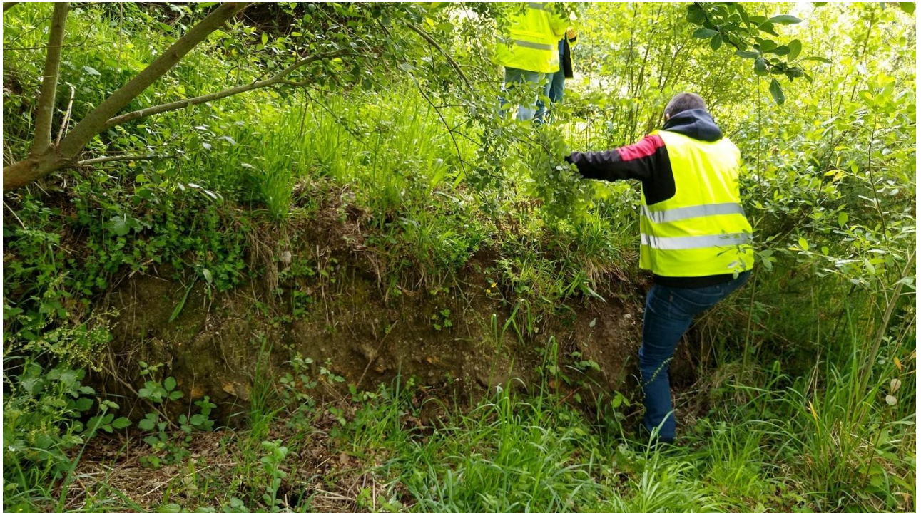
Grieta de tracción (0,8 m) en cabeza de talud.
