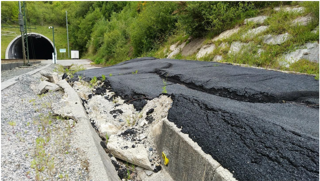
Estado del drenaje de la cuneta margen izquierdo de la misma plataforma de emergencia.
