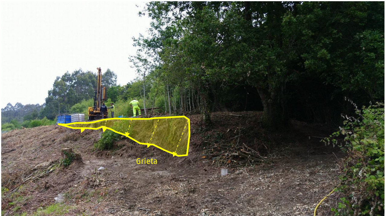
Grieta de tracción en coronación de talud (2,5m de altura máxima).
