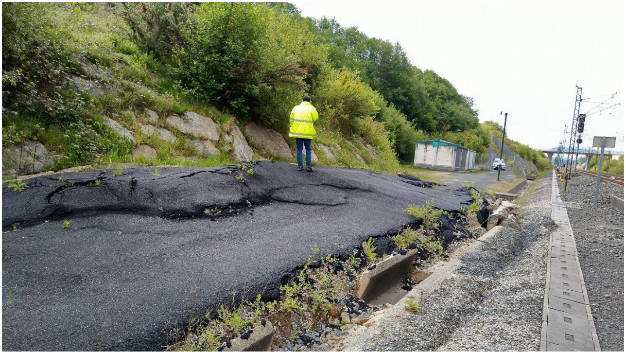
Cuneta margen izquierdo del mismo vial. Vuelco de la cuneta.
